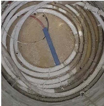
Luftverteiler mit Heizspirale
