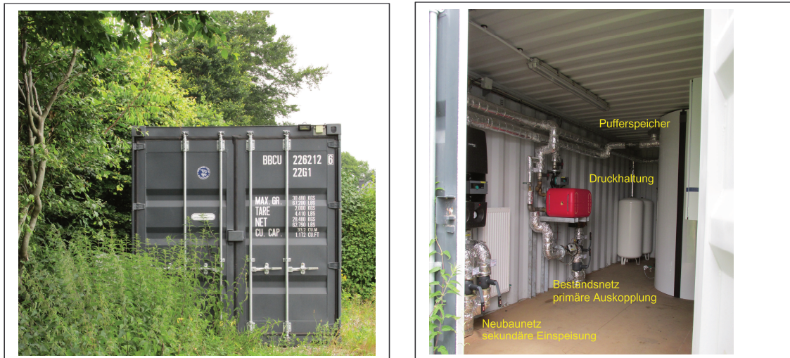
Abbildung 3 Ansichten der ausgeführten Netzauskopplung
