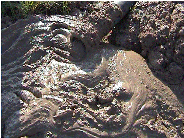
Abb. 95: Gemengeaustritt am Pumpenschlauch
