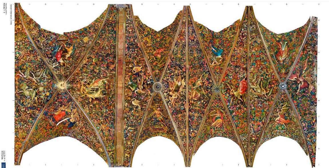
Abb. 73: Entzerrte Gesamtaufnahmen der Gewölbe der Schlosskapelle Bückeburg, gefertigt als Kartierungsvorlage von der Fa. Fokus GmbH Leipzig (2012)
