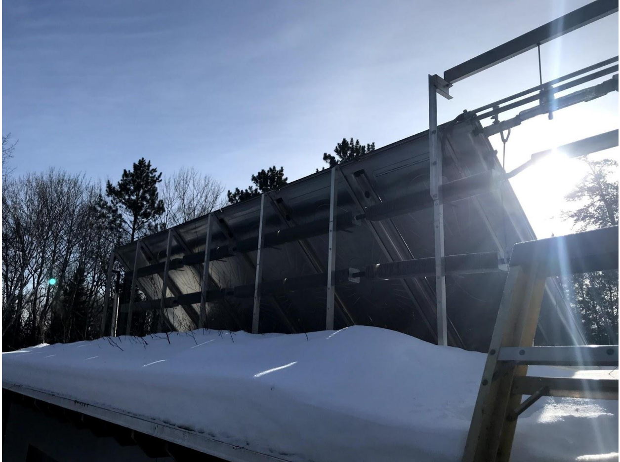
Ein Blick auf die solare Warmwasseranlage von hinten.
