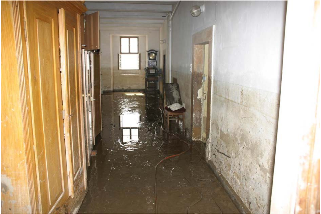
Abb. 1 Kloster St. Marienthal, Propstei, Blick in einen hochwassergeschädigten Flurbereich
