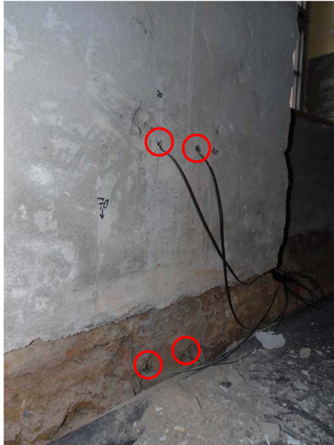
Abb. 36 Klimasensor der Firma Driesen+Kern GmbH im eingebauten Zustand in der Wand. Die Kreise markieren die vier Messpunkte
