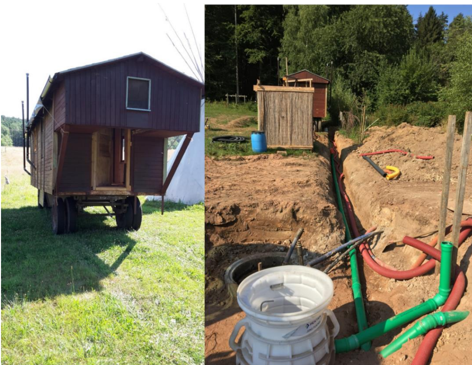
Abbildung A4.32: links: Sanitärwagen auf dem Campingplatz; rechts: Grauwasserleitung und Urinleitung vom Sanitärwagen
