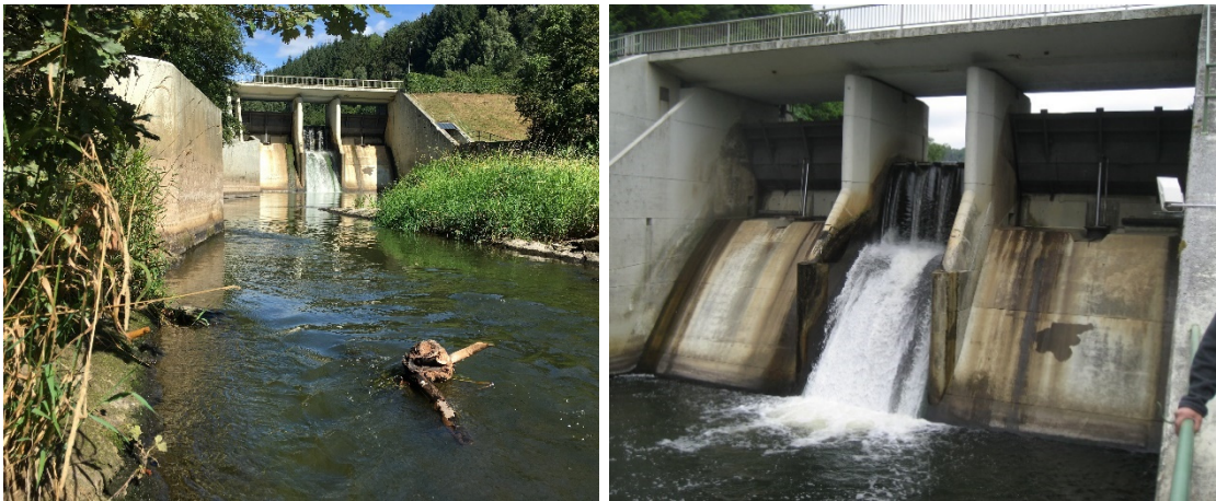
Abbildung 5: Absperrbauwerk des Stausees Bitburg mit 3 Wehrfeldern und anschließendem Tosbecken (Fotos: Küppers)
