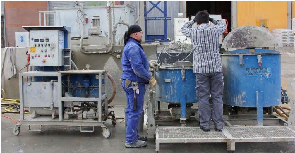
Abbildung 5: Anlage zur Herstellung des mineralisierten Dämmschaums.
