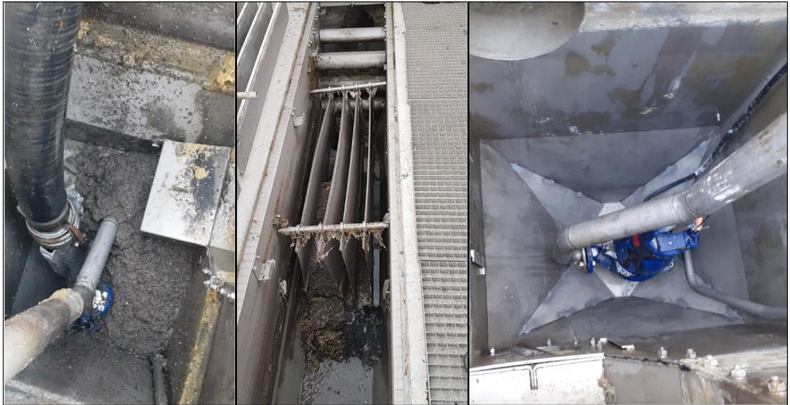
Abbildung 3-11: Sandablagerungen im Pumpensumpf (links) und LWSF (mitte) vor Anpassung des Pumpensumpfs, Einbauten Pumpensumpf nach Anpassung (rechts)
