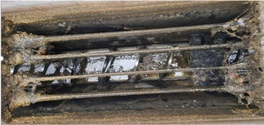
Abbildung 3-10: Anfang einer Brückenbildung infolge überströmter Leitwandbefestigung
