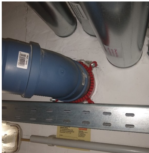
Abbildung 29: Ein schallsoliertes Kunststoffrohr hat geringe Wärmeverluste - hier mit Brandschutzmanschette bei Mauerdurchführungen.
