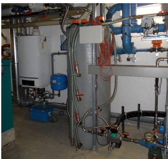
Abbildung 7: Ungedämmte blaue Grauwasserleitungen - links daneben der 400 Liter fassende ebenfalls ungedämmte Wärmepufferspeicher im warmen BHKW Heizungsraum.
