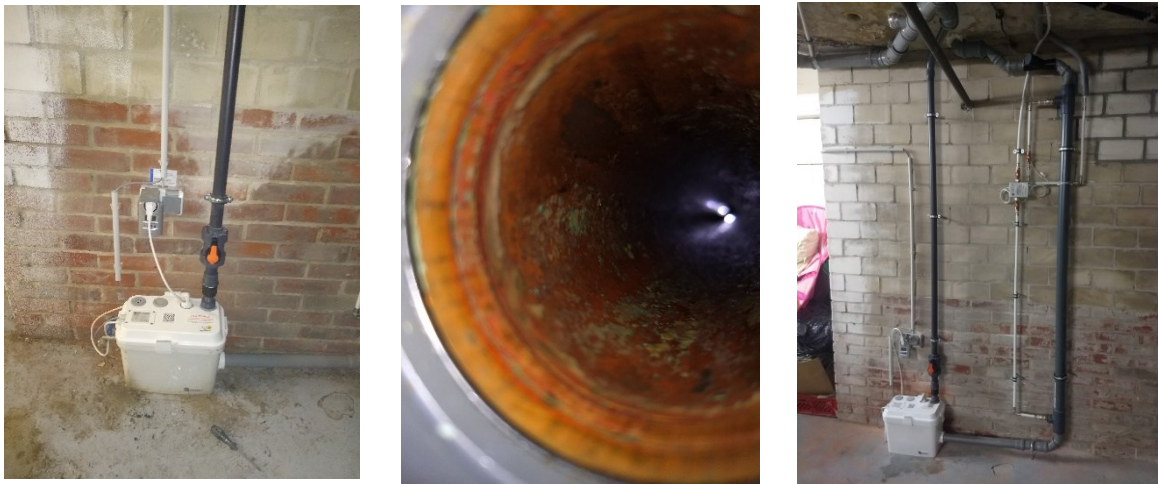
Abbildung 32: Duschröhr eingebaut mit Wärmemengenzähler, und Hebeanlage für eine Gemeinschaftsdusche in einer Berliner Obdachloseneinrichtung. Bild Mitte: Das Duschröhr - 6 Monate nach der letzten Inspektion.
