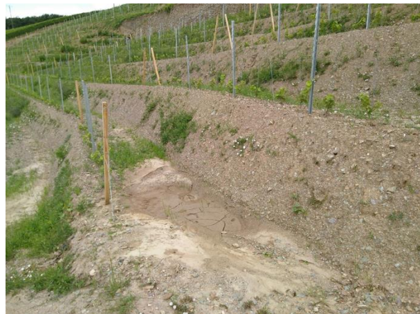
Abbildung 26: Kaum sichtbare Erosionsschäden in einer neu erstellten Querterrassenanlage. Erkennbar ist eine Verlagerung der Einsaat im Böschungsabschnitt und eine Feinerdeansammlung auf der Terrassenplattform nach einem Starkniederschlagsereignis am 09.06.2018.
