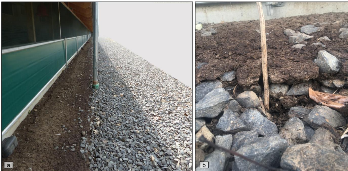
Abbildung 20: Überdachter Stallrandbereich und angrenzender Nahbereich mit Gleisschotterbett (a), Nahaufnahme der starken Kotauflage auf und zwischen dem Gleisschotter im überdachten Stallrandbereich (b) (Aufnahmen vom 06.08.2019)
