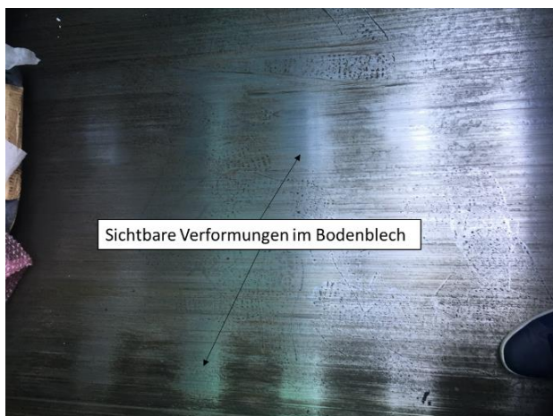
Abbildung 6-30: Sichtbare Verformungen im Bodenblech
