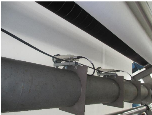
Abb. 6.1: Montage der Mikrowellensensoren hinter dem Saugbalken (im Vordergrund) einer Textilveredelungsanlage der Fa. Thorey
