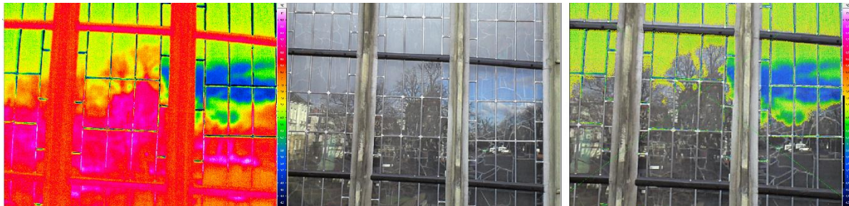
Abb. 15: Nebeneinanderstellung eines Thermogramms der Außenschutzverglasung der Nordfassade der Liebfrauenkirche in Liegnitz. Links: Thermogramm mit Temperaturbereich (TB) 4 °C (blau) bis 10 °C (pink); Mitte: Farbfoto des gezeigten Bereichs; Rechts: Überlagerung des Fotos mit TB von 4 °C bis 7,5 °C.
