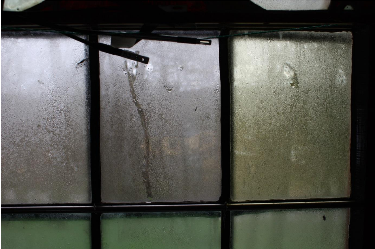
Bild 57: Tauwasserbildung auf der Innenseite der Schutzverglasung im April 2019, beim Ausbau der Messtechnik beobachtet.
