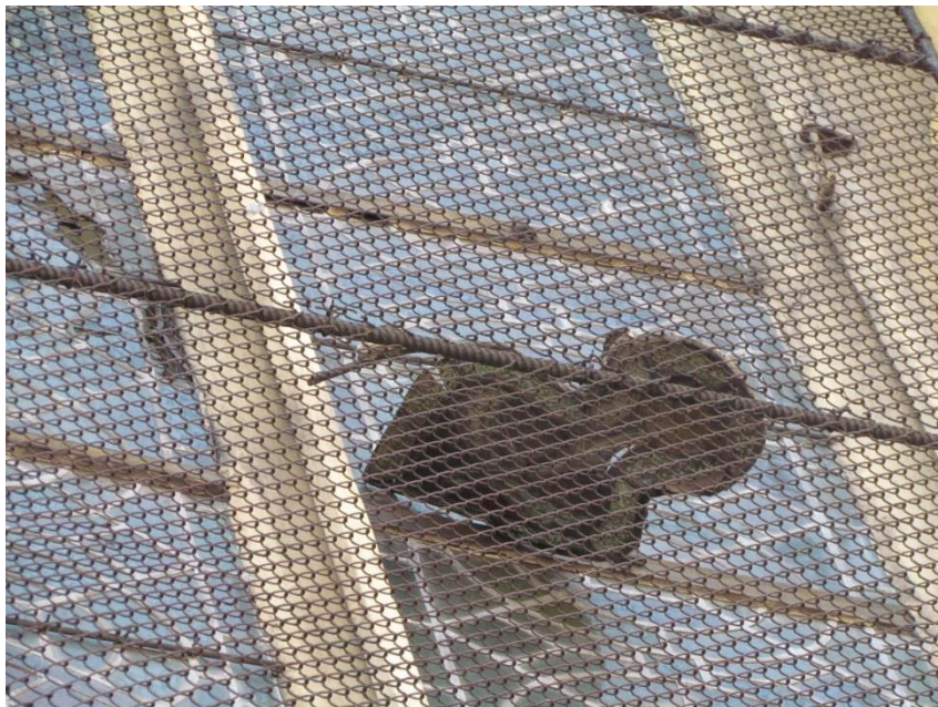
Bild 9: Fenster nX, Glasstück aus Maßwerk und Schäden in Feld 6b
