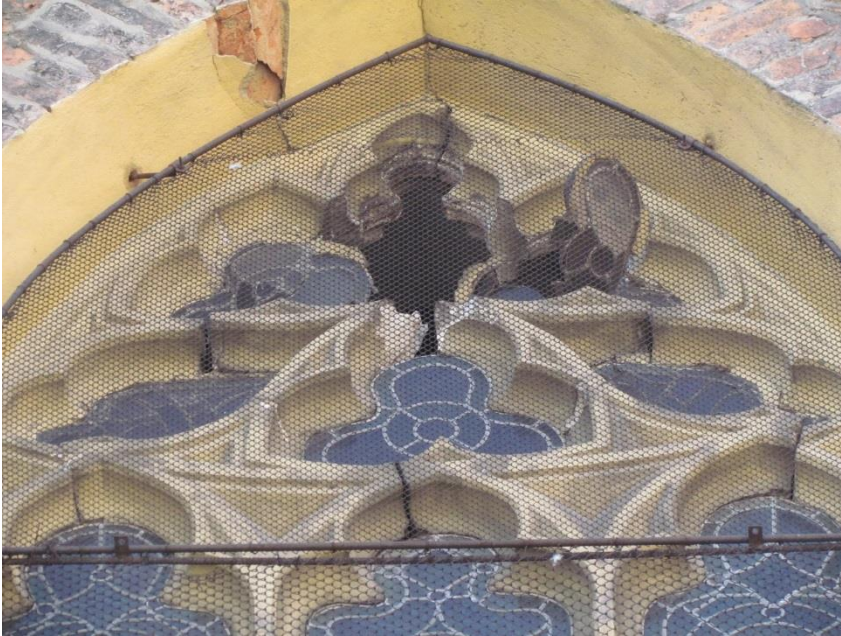
Bild 8: Fenster nX mit Schäden im Maßwerk
