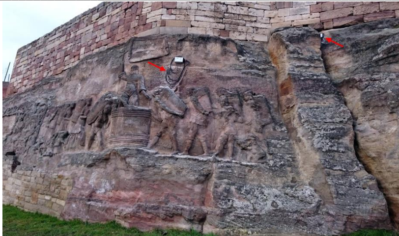
Abb. 37: Relief Christus in der Kelter . Die Impedanz- und Bohrlochklimasensoren sind auf dem Bild oberhalb der Buttenträgerin, rechts des Weinkelers installiert. Die Klimasensoren für die Messung liegen im Schatten, am oberen Ende der Felsspalte (rechter Pfeil).
