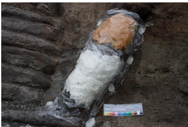
Abb. 103: Musterfläche mit Ionentauscher Akeogel (oben) und Ammoniumkarbonat (unten) im Reliefs Christus in der Kelter , im Bereich mit schlechter Wasseraufnahme
