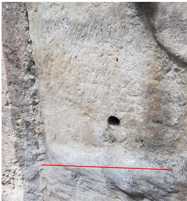
Abb. 124: Bohrkernentnahmestelle am unteren Rand der li., unteren Musterfläche, hellgraue mittelkörnige Varietät, Vorzustand vor der Injektionsfestigung. Die rote Linie markiert den unteren Rand der Musterfläche mit KSE 300.
