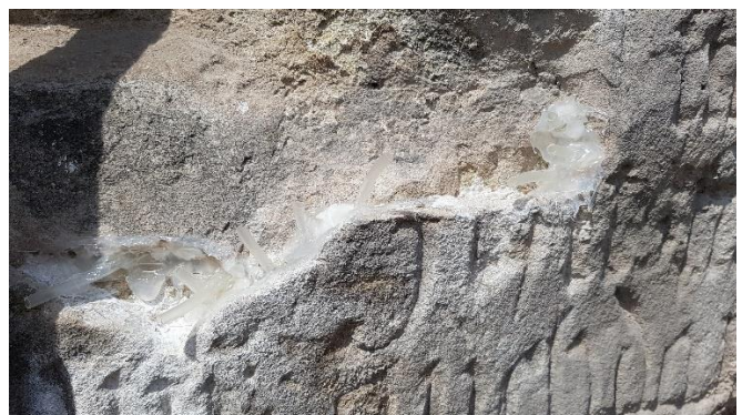
Abb. 151: Nahaufnahme der Oberkante der hohl liegenden Schale – mit Heißkleber abgedichtet und mit Injektionsschläuchen versehen.
