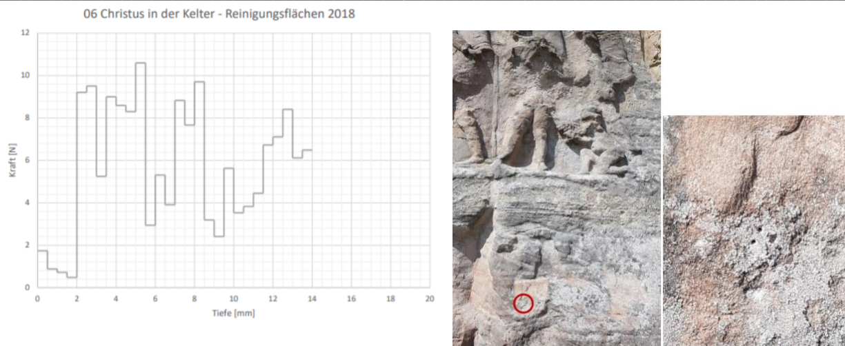
Abb. 74: Bohrwiderstandsmessung zur Charakterisierung des Einflusses der Flechten auf den Untergrund, Messfläche 06, Relief Christus in der Kelter
