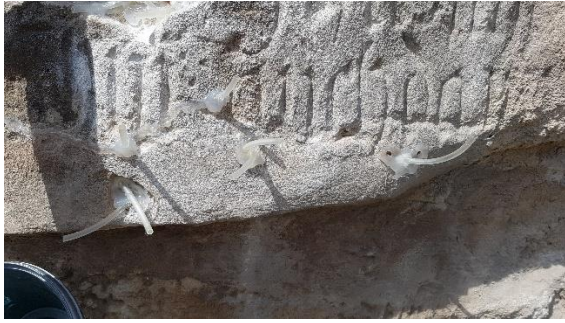
Abb. 152: Schläuche zur Injektion im unteren Bereich der zu hinterfüllenden Platte, eingeklebt mit Heißkleber.
