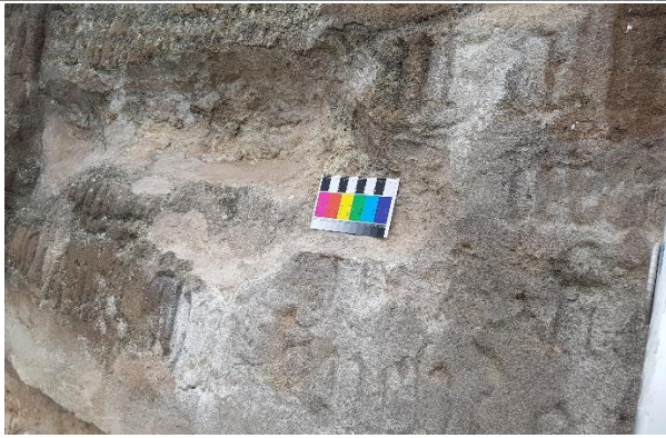
Abb. 148: Inschriftentafel im Relief Christus in der Kelter mit großen Fehlstellen und unzureichender Anwendung des Injektionsmörtels. Der Mörtel liegt auf der Schalenflanke auf und führte ringsherum zu Schleiern.
