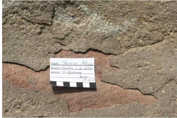
Abb. 144: Ergänzung (Remmers weich) mit Flankenablösung. Das darunterliegende Gestein sandet stark. Die Ergänzung erscheint zu hart
