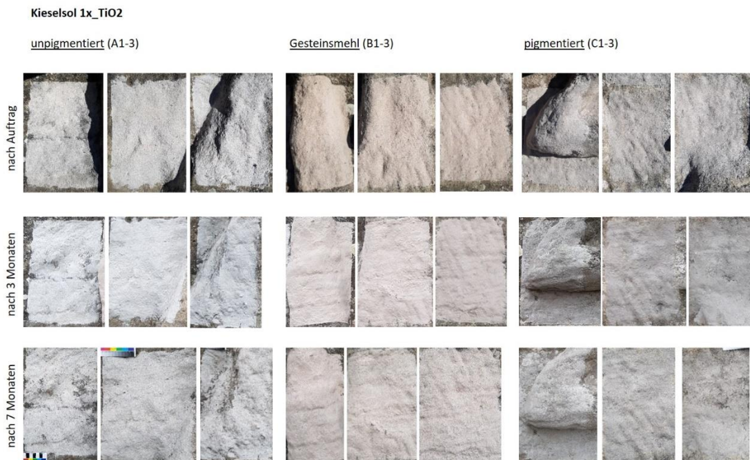
Abb. 87: Musterflächen mit einmaligem Schlämmauftrag Kieselzol mit TiO 2 -Zusatz am Relief Fuchsjagd in einer Zeitschau nach dem Auftrag, nach 3 Monaten und 7 Monaten.
