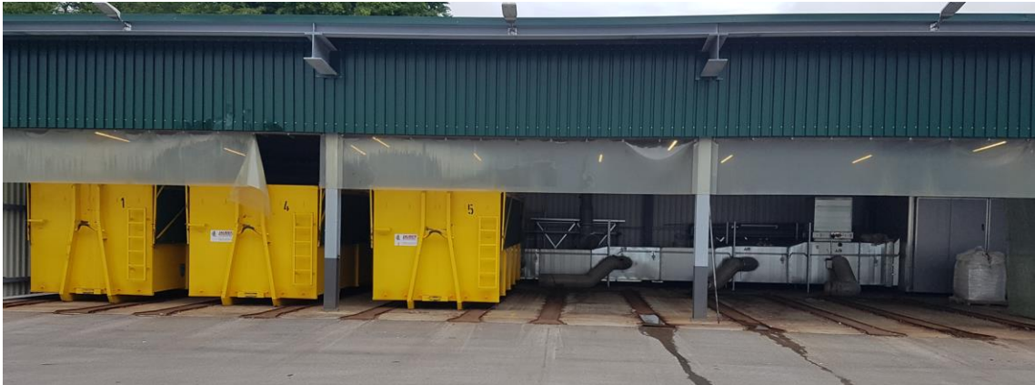
Abbildung 41: Halle mit Trocknungscontainern (3 der 6 Plätze besetzt)
