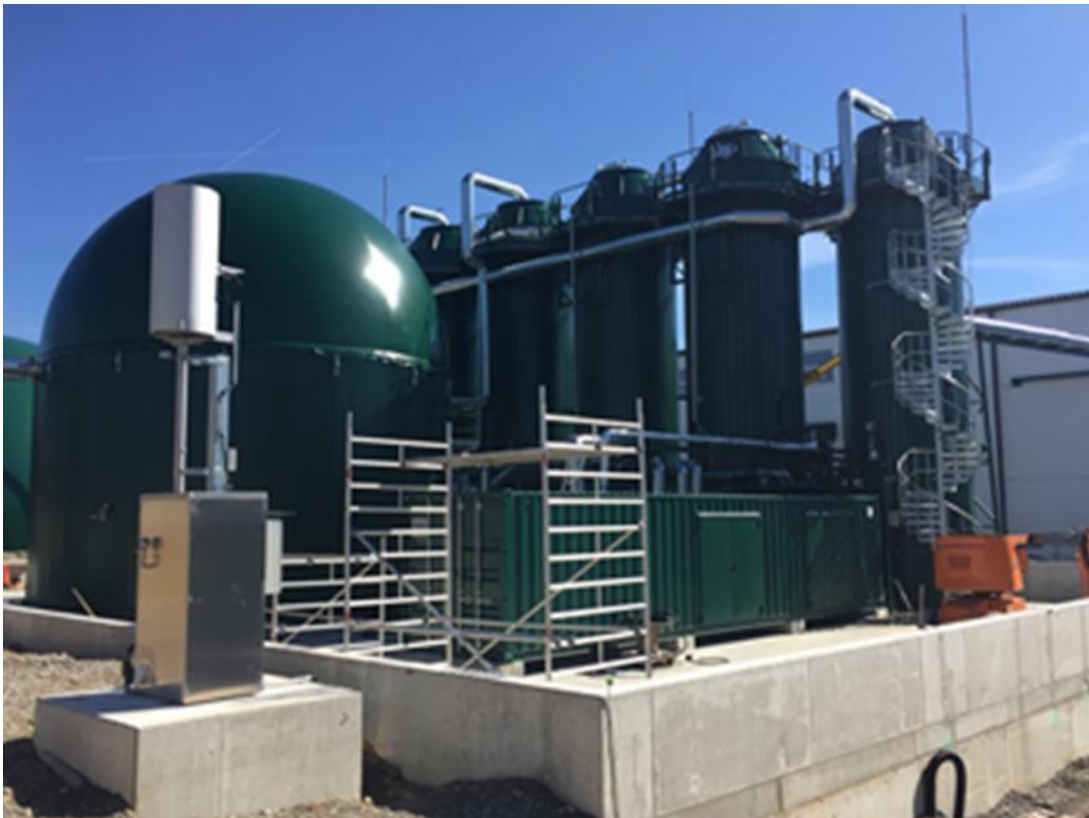
Abbildung 4: Vergärungsanlage in Erbenschwang mit Vorlagebehälter, 2 Festbettfermenter, 2 Nachfermentern und dem nachgeschalteten Rührkesselfermenter (links) (Quelle: Fa. Sutco)
