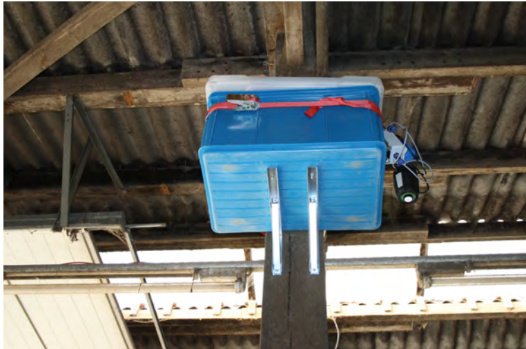
Abb. 62.: Box zur Aufbewahrung des INNOVA 1302 mit angehängtem Polytron C300 zur NH_3 -Messung der Stallluft
