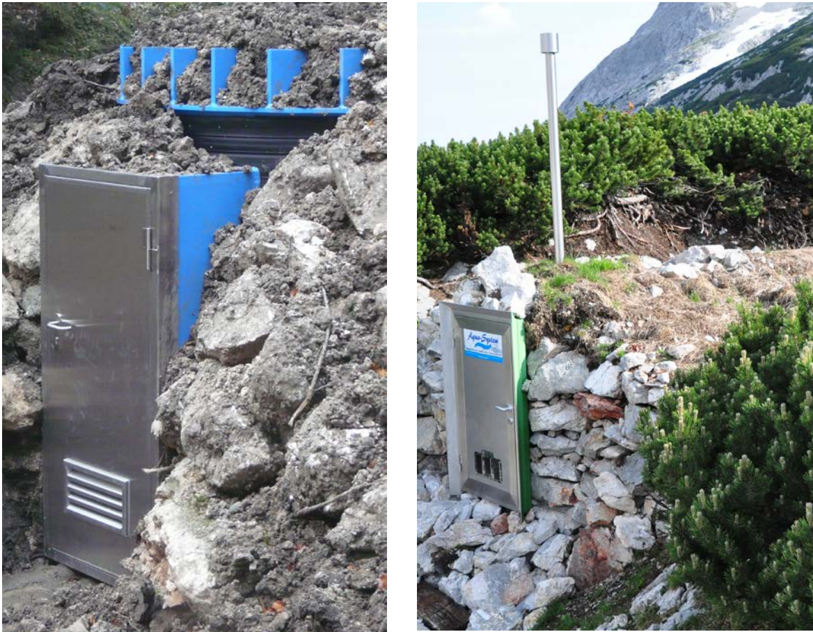
Abbildung 3-11: seitlicher Zugang zu Behälter. Quelle links DAV; rechts W. Kunrath
