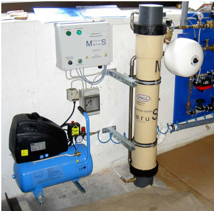
Abbildung 3-22: Ultrafiltrationsanlage. Quelle: WiB Heider
