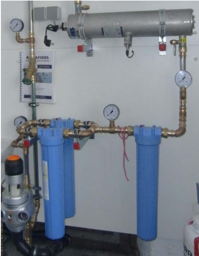
Abbildung 3-21: Kombination aus spülbarer Vorfilter, zweistufigem Feinfilter und UV-Desinfektion auf der Meilerhütte. Quelle: Wiesböck
