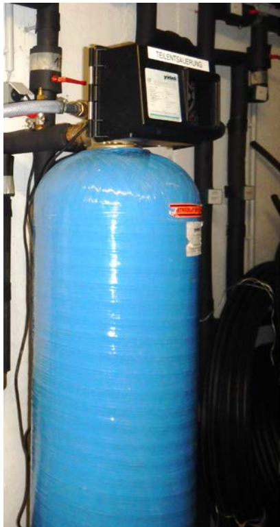
Abbildung 3-23: Geschlossener Filter zur Teilentsäuerung
