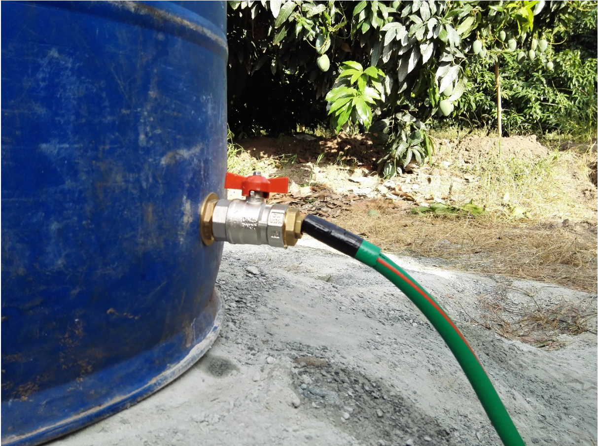
Abbildung 23: Abgedeckte Schlauchleitung an der Zulauf-Armatur
