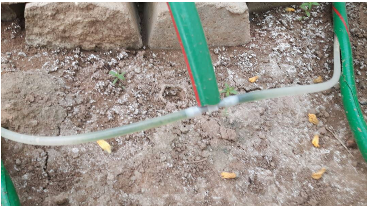
Abbildung 9: Algenbildung im Bereich der über dem Erdboden gelegenen Schläuche
