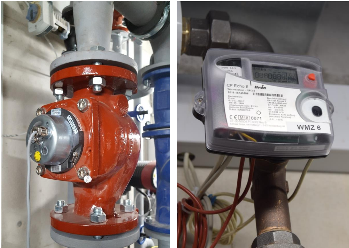
Abbildung 60: Wärmemengenzähler in der großen Ausführungsvariante (links) und der kleinen Ausführungsvariante (rechts).
