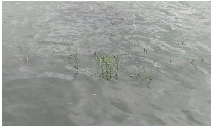
Abbildung 44: In Folge von zu hohem und zu häufigem Wellengang gesunkener Gabionenkörper im Mittellandkanal
