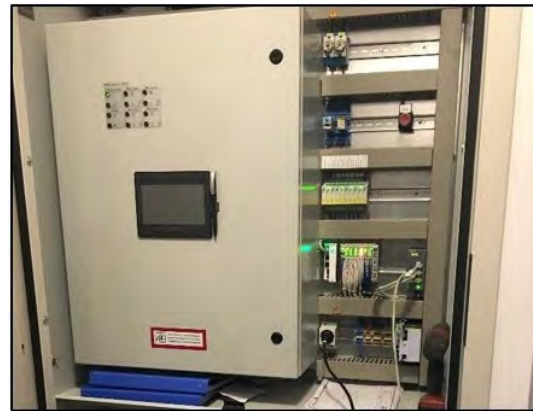
Baufeld H1B, Schaltschrank
