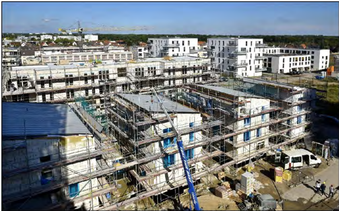
Bild 29 Blick auf die Baufelder im ersten Bauabschnitt aus dem September 2020 – Im Vordergrund Baufeld I1 - Reihe
