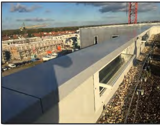
Baufeld H1A Nord, geöffnete Klappen
