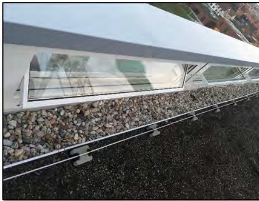
Baufeld H1B West, eine Klappe defekt
