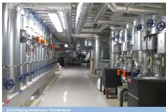
Ertüchtigung Infrastruktur: Technikräume
