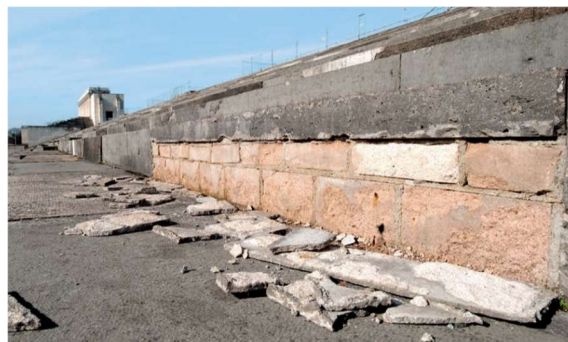
Bild 6: Materialverlust im Außenbereich der Zeppelintribüne 2013 (Presse- und Informationsamt Stadt Nürnberg)
