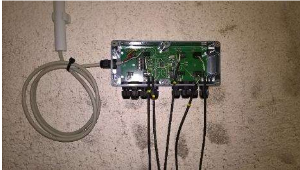
Bild 24: Verkabelung des Multiplexers
