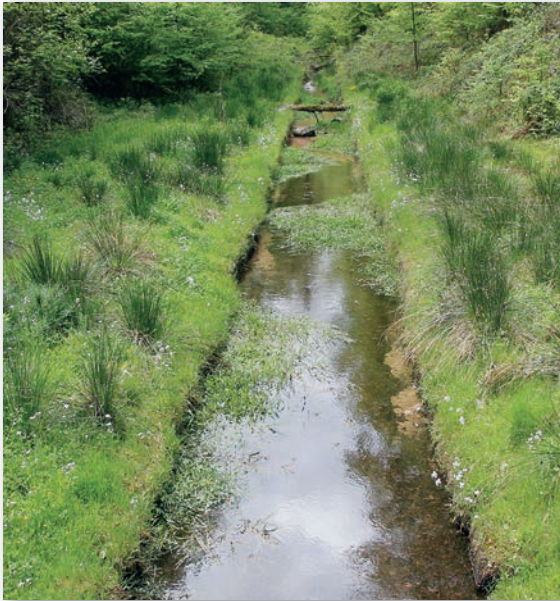
Abb. 10: Ein im 19. Jahrhundert zum Triftkanal umgebauter Bach im Pfälzerwald. Die Ufer sind mit großen Sandsteinblöcken befestigt. Sehr deutlich wird hier der Konflikt zwischen ökologischer Funktionsfähigkeit und Denkmalschutz.
