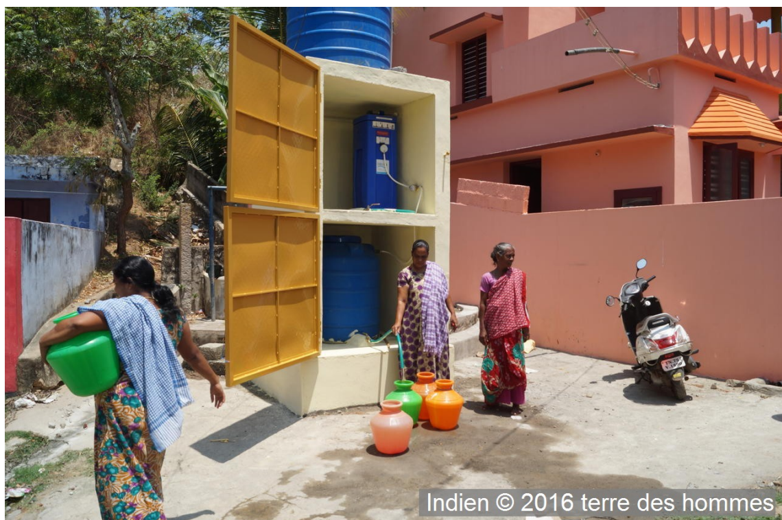
Bild 19: Keela Muttom – fertige Station in Betrieb
