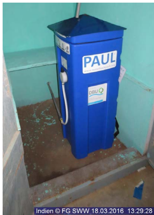
Bild 10: St. Jude School – Reinwassertank
