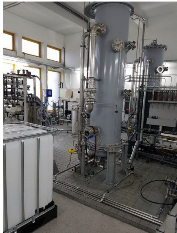
Abbildung 2. Säulenversuchsanlage der Stadtwerke Düsseldorf mit Rheinwassercontainer (vorne links).
