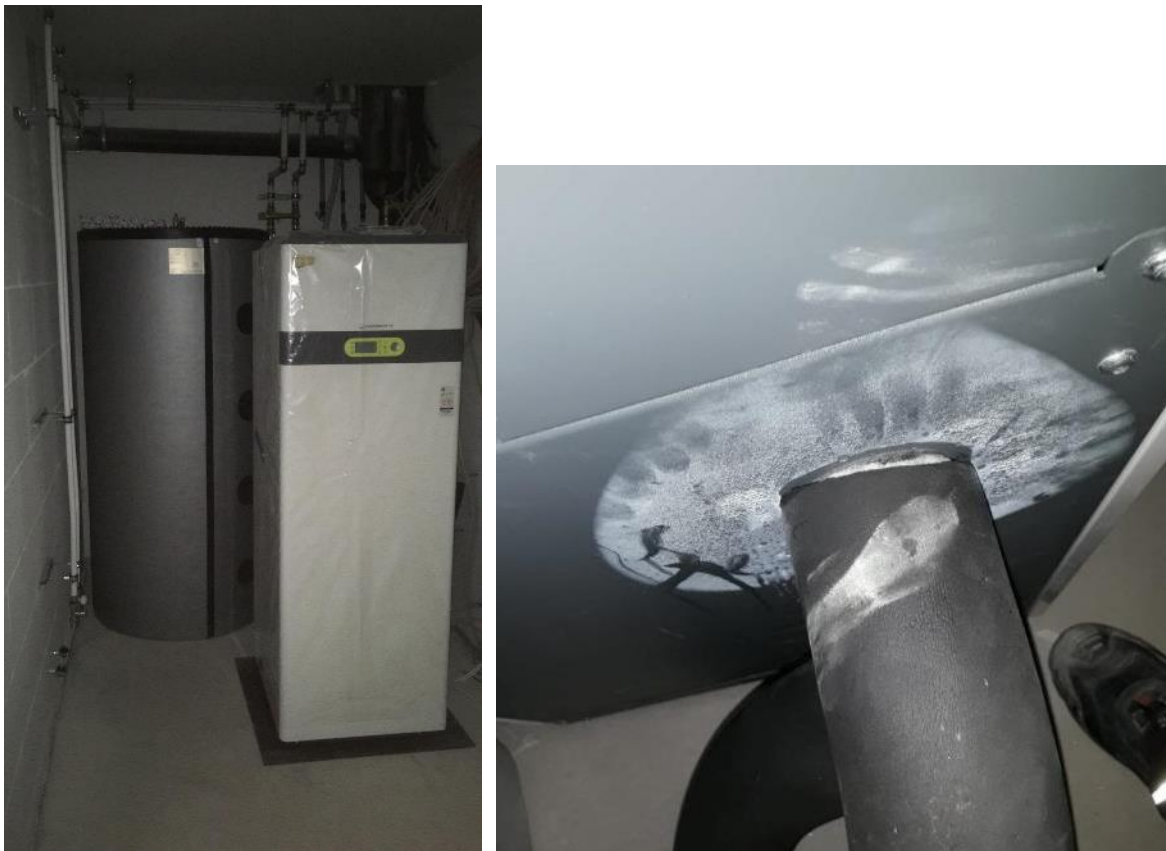
Abbildung 66: Links: Beispiel für beengte Platzverhältnisse in Technikraum. Rechts: Nicht ausreichende Wärmedämmung der Wärmepumpe für die auftretenden tiefen Temperaturen – hier allerdings eine Woche Non-stop-Betrieb und hohe Feuchte beim Estrich-Aufheizen.
