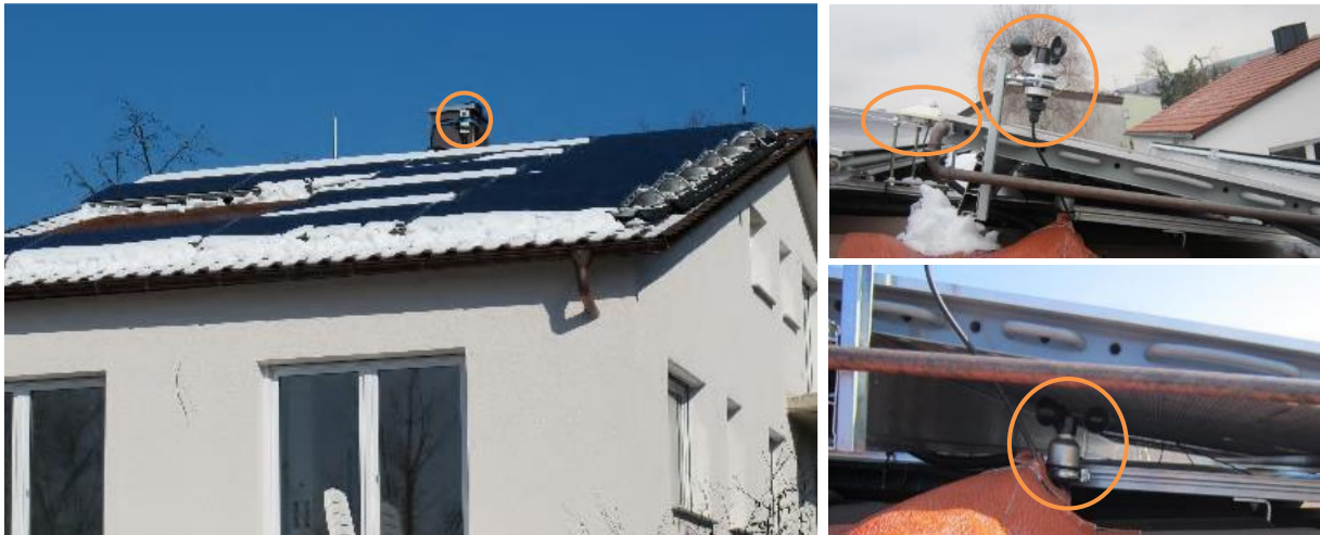
Abbildung 74: Messtechnik zur wissenschaftlichen Überwachung der Feldtestanlage in Korb (Stuttgart): Kamera 1 für Zustand der Kollektoroberfläche (links), Pyranometer und Windsensor in Kollektorebene (rechts oben) sowie Windsensor unterhalb des Kollektor-Wärmeübertragers (rechts unten).
