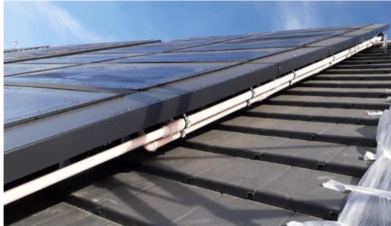
Abbildung 63: Kollektorfeld mit seitlichen Abdeckblechen, unter denen die Soleleitungen verlaufen
