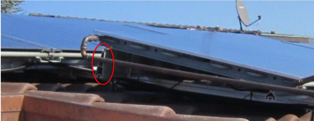
Abbildung 85: Aufgeständerte Kollektormontage bei der Feldtestanlage 1: das geschlossene Aufständersprofil (Oberkante Kollektor, rot markiert) behindert die Hinterlüftung des Kollektors.
