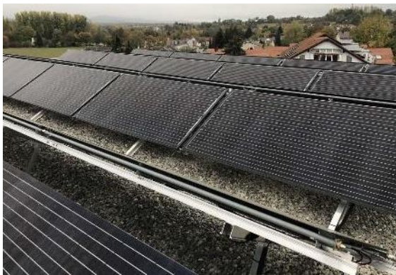
Abbildung 62: Auf dem Flachdach aufgeständert montierte SOLINK-Kollektoren (Ost-West)
