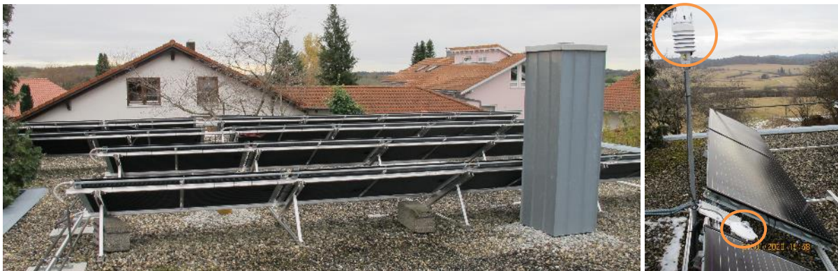
Abbildung 75: Rückseitiges Kollektorfeld (links) und Messtechnik zur wissenschaftlichen Überwachung der Feldtestanlage Sonnenbühl (rechts): Wetterstation zur Erfassung von Windgeschwindigkeit, Windrichtung und Niederschlag sowie Pyranometer zur Erfassung der Einstrahlung in Kollektorebene.
