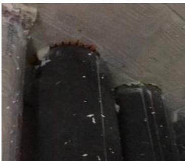
Abbildung 65: Rohrleitungsdurchgang durch Decke mit brandschutztechnisch zugelassener Dämmungsmanschetten für Durchgänge.
