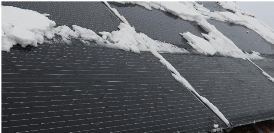
Abbildung 44: Beobachtete Tendenz zum Festfrieren/Anhängen von Schnee an den unbeheizten Lochblechen zwischen den Modulen während des Schneeabrutschens (am PVT-Kollektorfeld mit Lochblech-Spaltabdeckungen).
