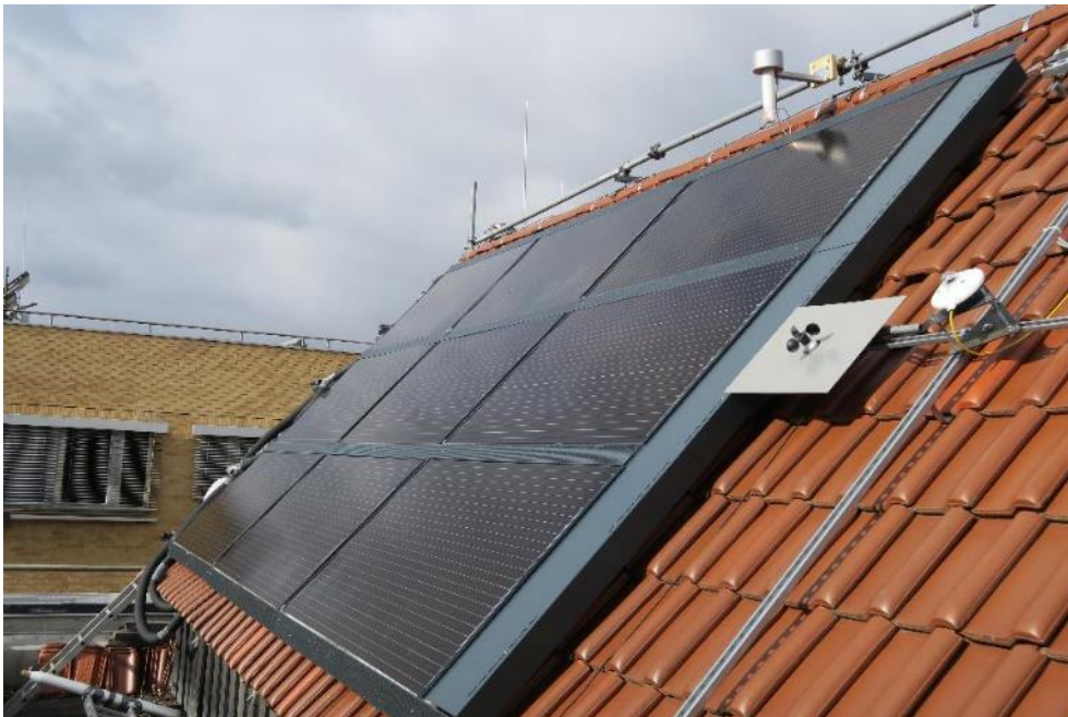
Abbildung 37: Kollektorfeld mit Lochblechen zwischen den PVT-Modulen und entlang der Ober- und Unterkante sowie einer geschlossenen Seiteneinfassung (Konfiguration D).
