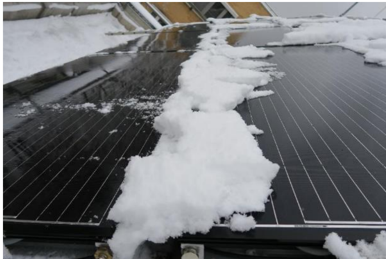
Abbildung 42: Tendenz zum Verfüllen der horizontalen Spalte während des Schneeabrutschens am PVT-Kollektorfeld ohne Spaltabdeckungen.
