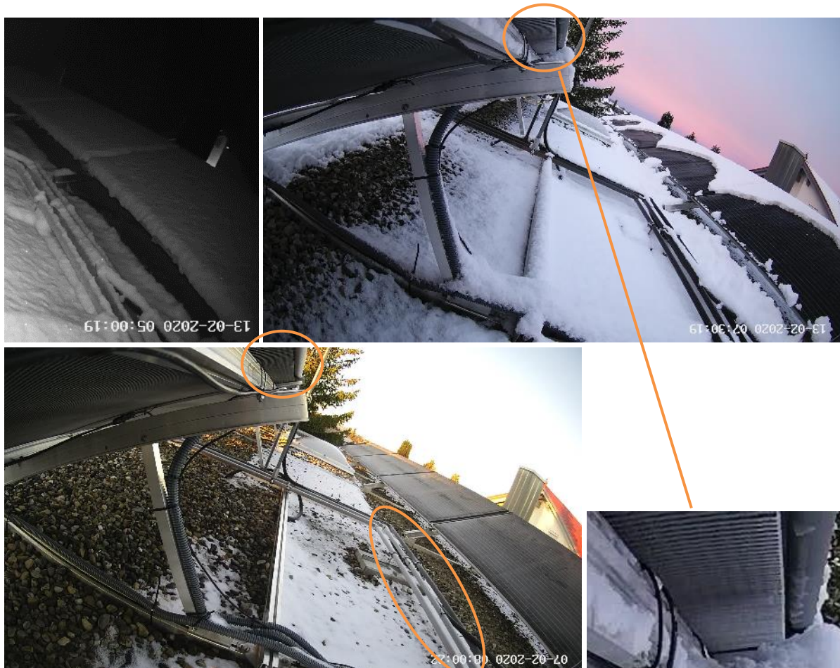
Abbildung 79: Kamerabilder der Feldtestanlage Sonnenbühl zu Schnee und Vereisung (Feb. 2020): - starker nächtlicher Schneefall (oben links) und Schneereste nach Abrutschfunktion (oben rechts) - leichte bis mäßige Vereisung der Verrohrung und der Wärmeübertrager-Lamellen (rot markiert; kein signifikanter Einfluss auf Wärmeübertragungsvermögen beobachtet, vgl. auch Abschnitt 3.4.4.4)
