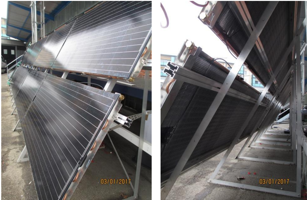
Abbildung 8: 8 Muster-PVT-Kollektoren an der Testanlage bei Consolar Lörrach
