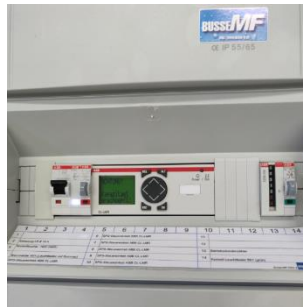
Abbildung 24: Steuerung der Kläranlage
