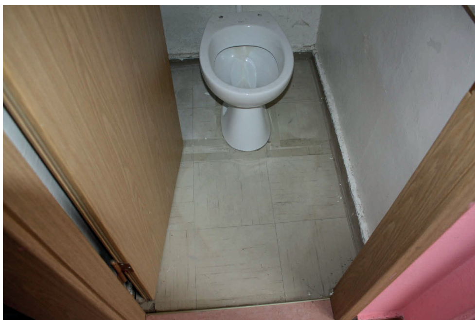
Foto 12: VC-Fliesenbelag, asbesthaltig (OG Süd, 1. Wohnung)
