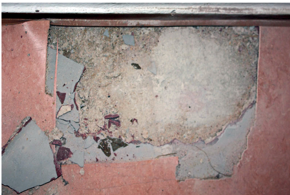
Foto 9: Holzzementestrich (Wohnung 1. OG, Süd)
