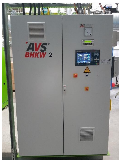
Abbildung 5: BHKW 2, Quelle: Aufnahme PATAVO
