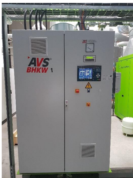
Abbildung 4: BHKW 1, Quelle: Aufnahme PATAVO
