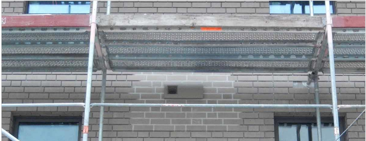
Abbildung 86 Fassadendetail mit Außenluftdurchlass der wohnungszentralen Lüftungsanlagen
