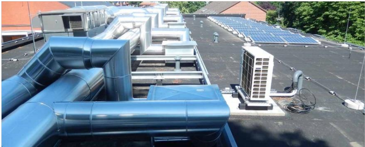
Abbildung 109 Gebäudetechnik im Dachbereich Zentrale Zu-/Abluftanlage mit Wärmerückgewinnung auf dem Dach. Photovoltaik für die Teil-Bereitstellung des Hilfsstroms und des Wärmepumpenstroms
