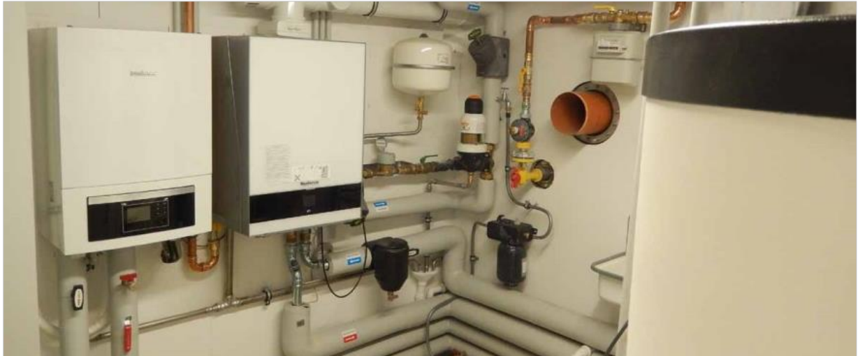
Abbildung 108 Gebäudezentrale mit Wärmepumpe und Gasbrennwerttechnik als Spitzenkessel
