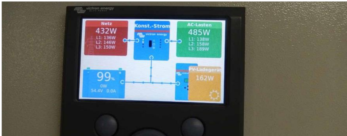
Abbildung 110 Display der Regelung mit der Darstellung der PV-Erträge und des Strombedarfs
