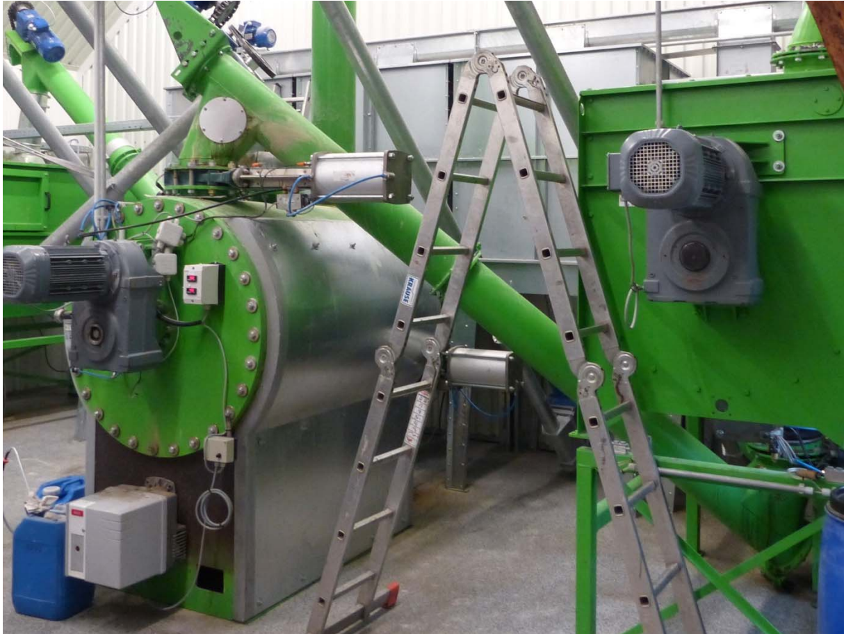
Abbildung 3-5: Halbtechnische Versuchsanlage mit Umwandler und Heizölbrenner (links) sowie Vormischer (rechts)
