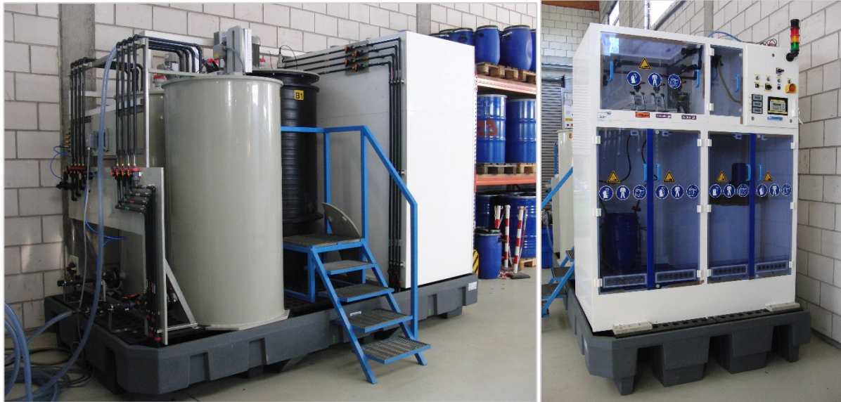
Abbildung 9: Hauptmodul, Behälter und Chemikaliendosierkabinett mit Schaltschrank
