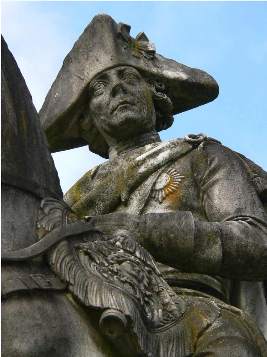
Abbildung 10: Verschwärzungen und biogener Bewuchs am Friedrich-Denkmal aus Carrara Marmor im Park von Potsdam-Sanssouci (Foto: K.Lange)
