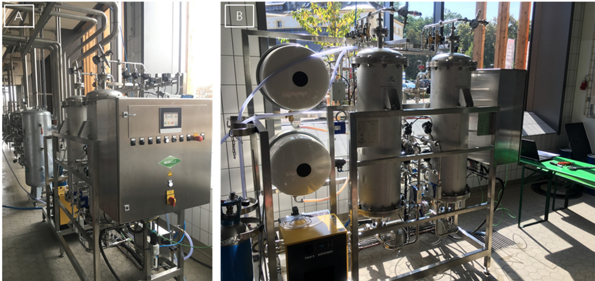
Abbildung 28: Aufstellung der Modellanlage im Gärungskeller 4: Seitenansicht (A), Frontansicht (B).
