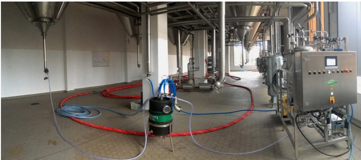
Abbildung 27: Aufstellung / Betrieb der Modellanlage.
