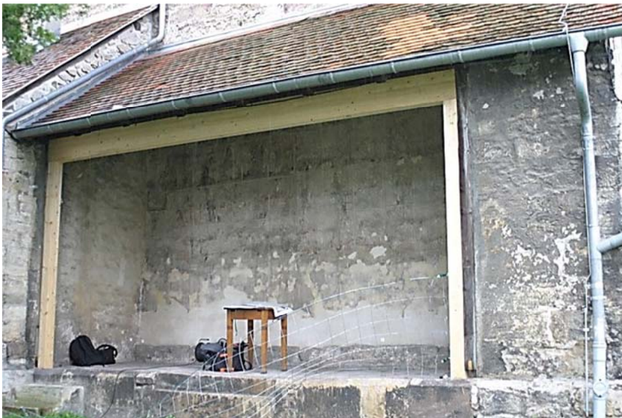
Abb. 16 Kirche St. Nicolai in Jena-Lichtenhain, überdachte Wandmalerei im nicht eingehausten Zustand Zeitraum: bis 2008
