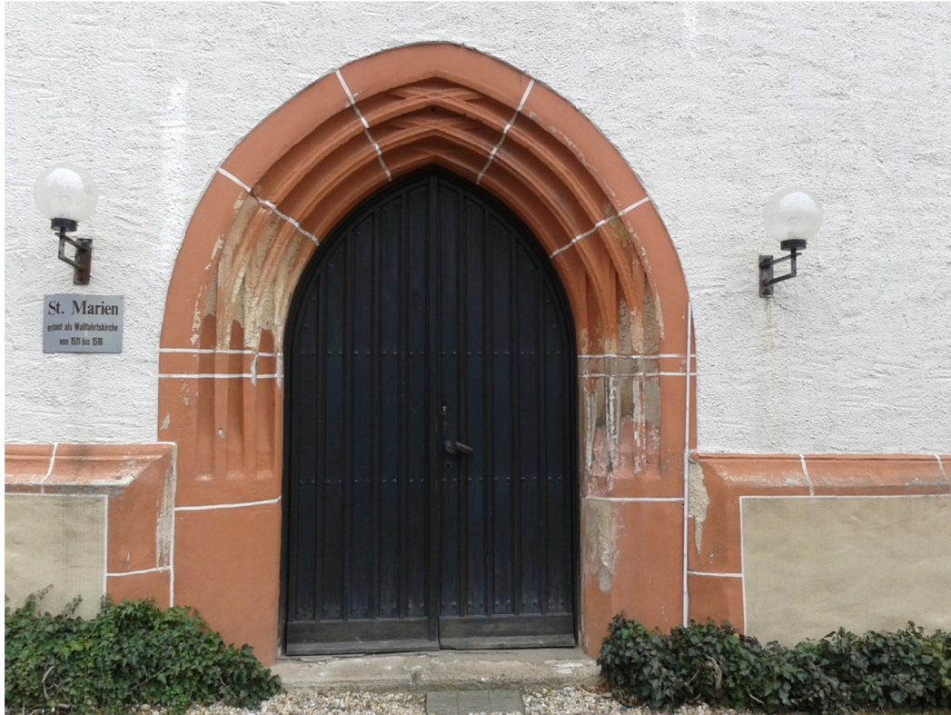
Rötha, Marienkirche, Westseite (Muster-)Portal und angrenzender Sockelbereich mit erheblichen Schäden an Natursteinoberflächen
