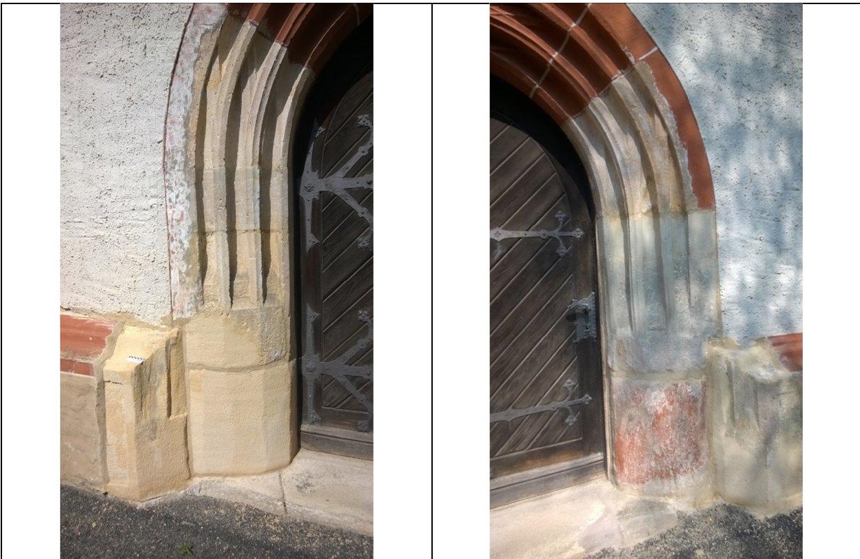
Abb. 33 Südportal: Antragung von Steingängungsmörteln nach Anpassung an die Tuffvarietät (links) und an die Vierung aus Zeitzer Sandstein (rechts)
