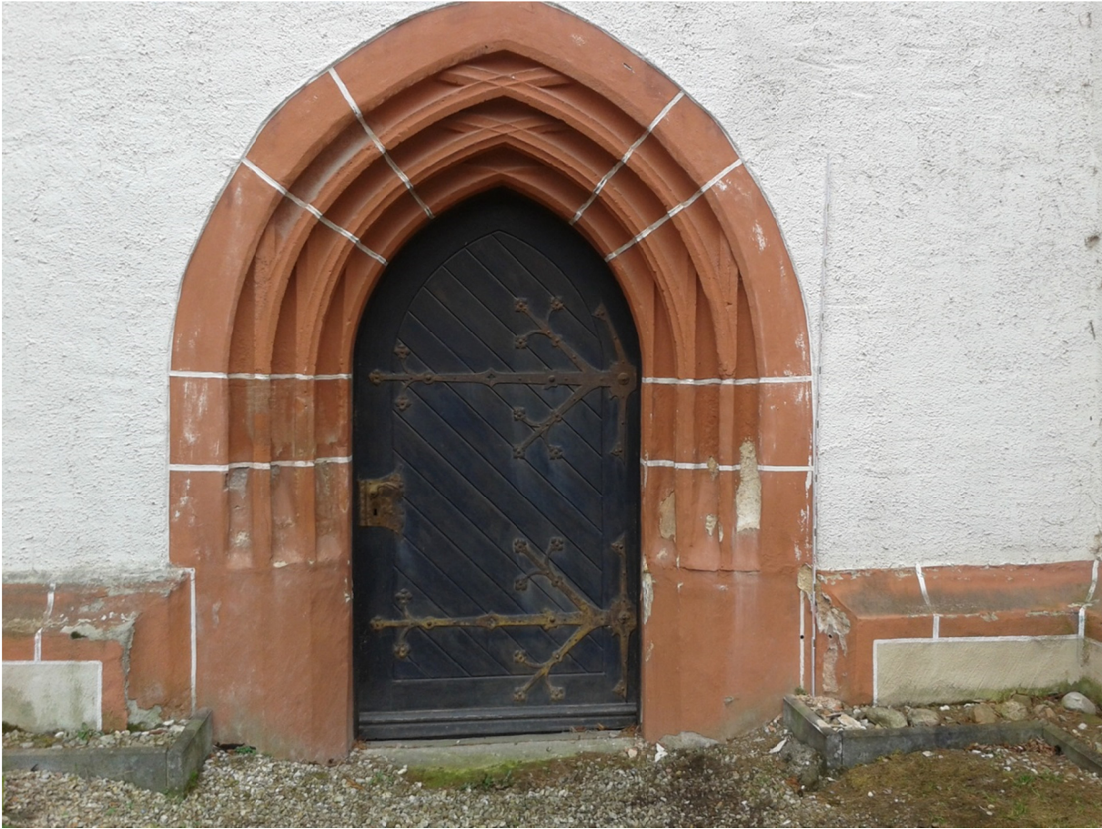
Rötha, Marienkirche, Nordseite, Portal und angrenzender Sockelbereich zeigen deutliche Schäden
