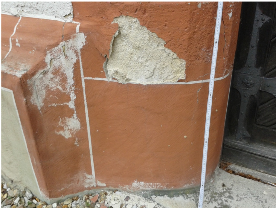
Rötha, Marienkirche, Südseite, Portalsockel. Der mit einer Sanierputzglätte überdeckte Naturstein zeigt starke Oberflächenverluste.
