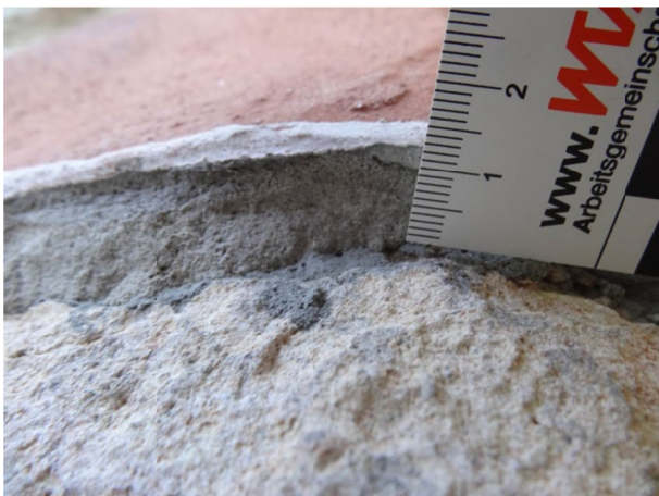
Abb. 10 Zementhaltige Glätte auf Natursteinoberflächen
