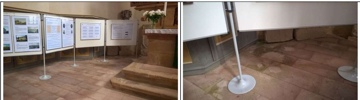
Abb. 27 Aufnahme und Untersuchung von Feuchteschäden im südöstlichen Chorbereich
