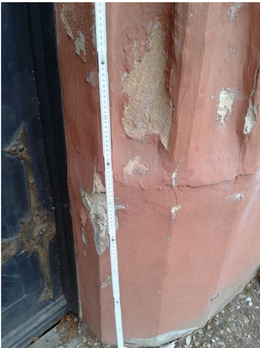
Rötha, Marienkirche, Nordseite, Portalgewände mit starken Schäden durch abgängige Glätte und Natursteinoberflächen
