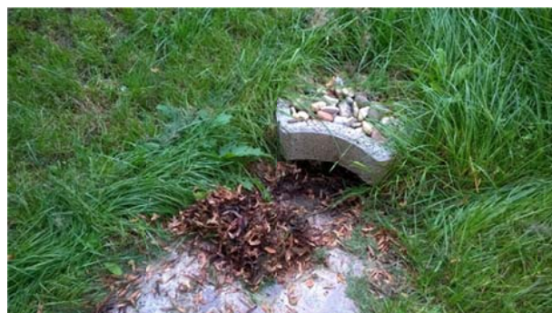
Abb. 26 Gottesgnaden, Kirche, Schiff, Einlauf in die Rigole, „Verstopfung“ (Aufnahme am 08.08.2017)
