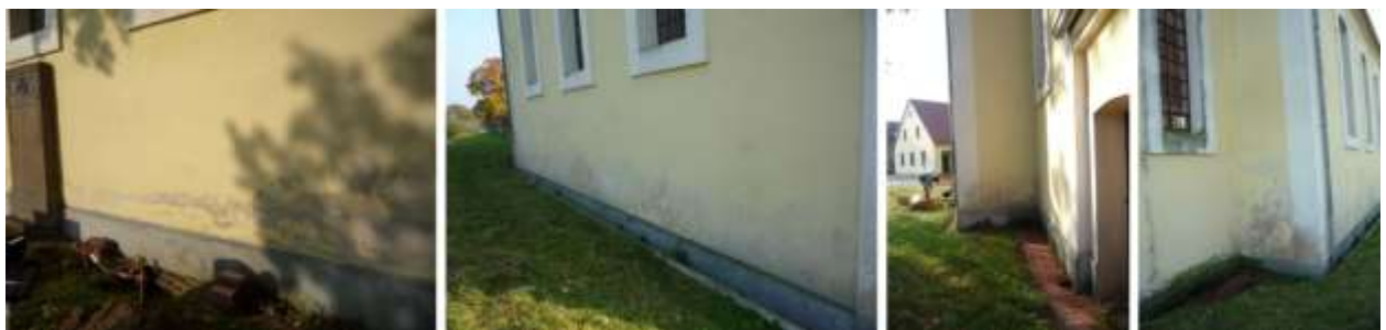
Abb. 7: Fleckige und schadhafte Bereiche oberhalb des Betonsockels
