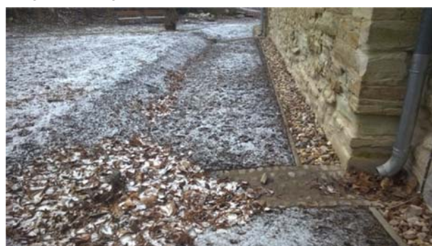
Abb. 22 Gottesgnaden, Kirche, Südfassade, Blickrichtung West, Ableitung des Regenwassers in die Rigole, „Verstopfung“ (Aufnahme am 07.02.2017)
