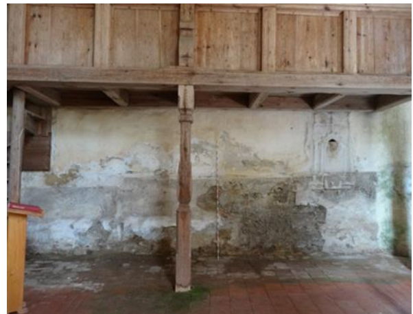
Abb. 15 Starke Feuchte- und Salzschäden sowie Vergrünungen im Innenbereich
