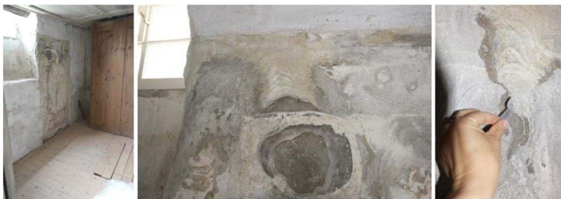
Abb. 7: Epitaph an der Ostwand der Kirche (Turm) mit massiven Salzkrusten im oberen Bereich (Probenahme)
