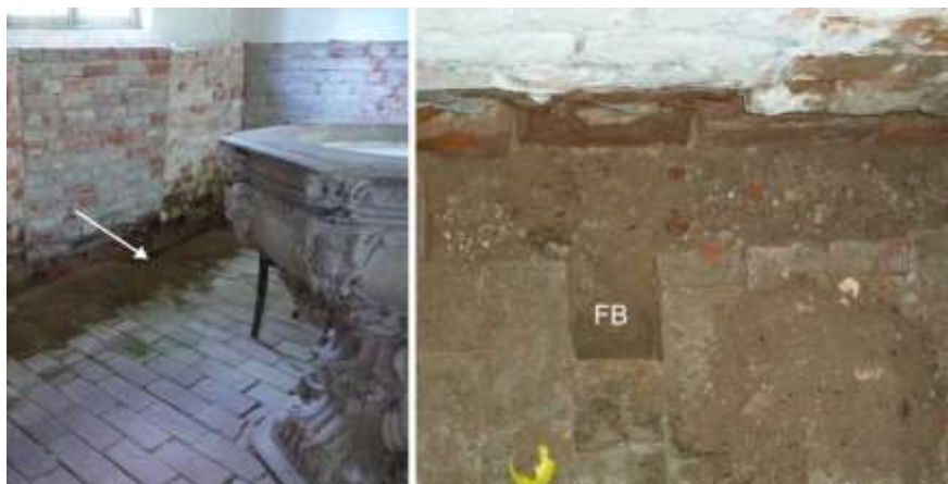
Abb. 4: Entnahmestelle der Fußbodenproben (Tiefenprofil), sehr feucht
