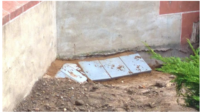
Abb. 17 Unzureichend abgedeckte Vertikalsperre
