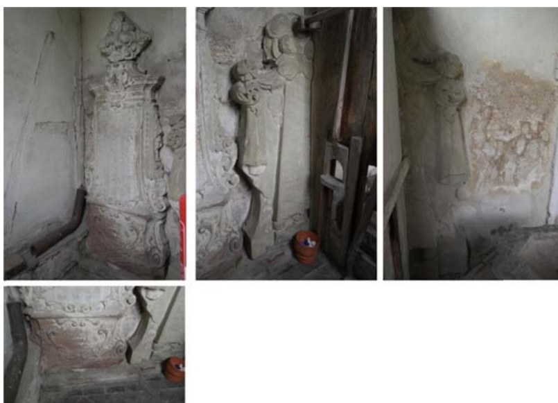
Abb. 10: Epitaphe im Vorraum, die aufgrund des festen Verbundes zu den Wandflächen Schäden aufweisen bzw. gefährdet sind.
