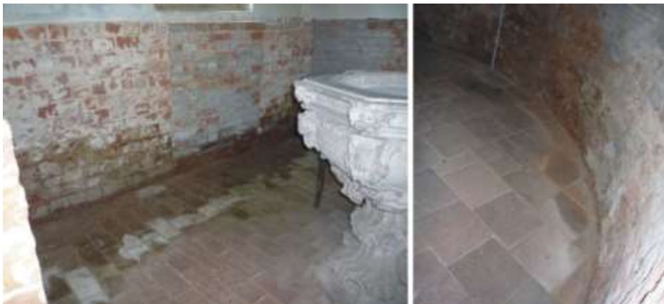
Abb. 6: Feuchte Bereiche in der Kirche
