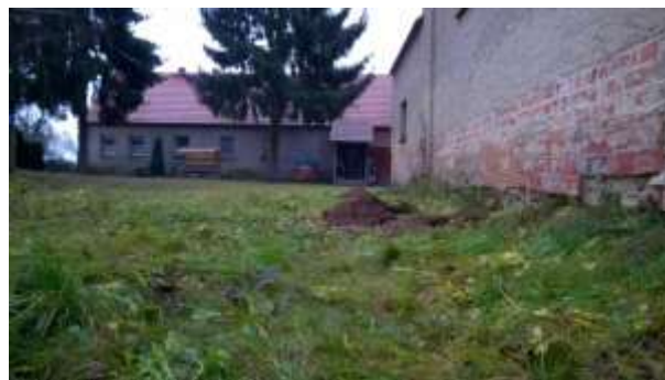
Abb. 9 Geländeunebenheiten führen zur Bewässerung der Fundamente
