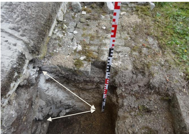
Abb. 14 Schurf mit freigelegter Vertikalsperre: falscher Einbau dieser führt zur „Bewässerung“ des Fundaments durch Schichtenwasser
