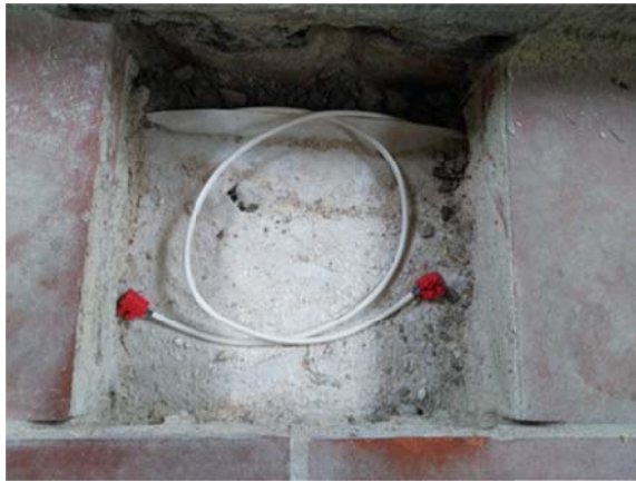
Abb. 18 Installation der Messfühler unterhalb des Fußbodens an der Treppe; Salzausblühungen auf der Oberfläche des Geotextils
