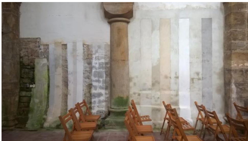
Abb. 13 Merseburg, Neumarktkirche, Bewertung verschiedener Putzmuster bei stark durchfeuchtetem Mauerwerk
