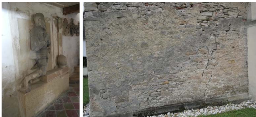
Abb. 6: Epitaph und Riss im angrenzenden Außenmauerwerk des Turmes.
