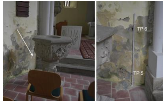
Abb. 12 Gottesgnaden, Kirche, Schäden
