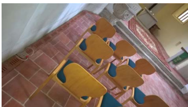
Abb. 7 Gottesgnaden, Kirche, Schiff, Nordwand mit neu eingebautem Lüftungstreifen
