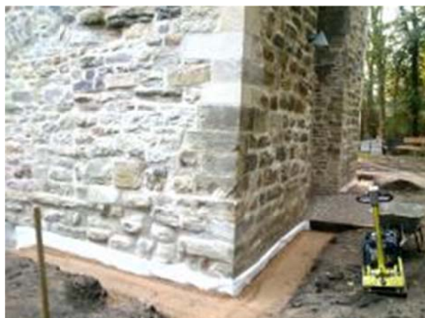
Abb. 11 Anlage der Vertikalsperre, die wurde Noppenbahn durch ein 2-lagig verlegtes Geotextil ersetzt (Foto: Buchmann)
