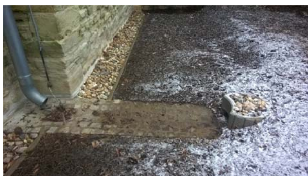
Abb. 23 Gottesgnaden, Kirche, Schiff, Nordfassade, Blickrichtung West, Ableitung des Regenwassers in die Rigole, (Aufnahme am 07.02.2017)
