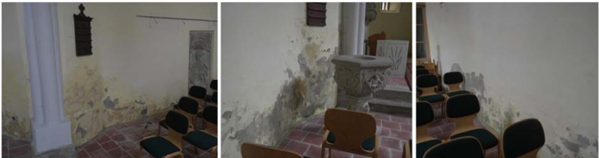
Abb. 1: Putzschäden auf der Nord- und Südseite des Kirchenschiffs
