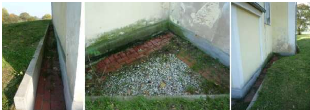
Abb. 8: L-Bauteile aus Beton mit eingelegtem Ziegelpflaster, worüber das Wasser in Richtung Osten abgeleitet wird.
