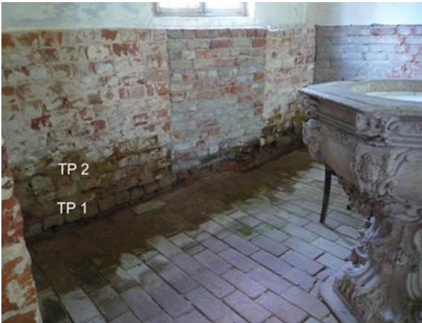
Abb. 11 Sydow, Kirche, Schäden
