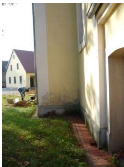
Abb. 9: Ziegelpflaster auf der Südseite der Kirche, worüber das Wasser in Richtung Osten abgeleitet wird.
