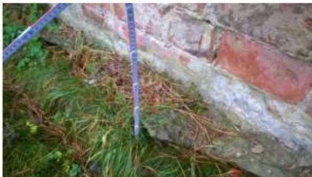
Abb. 10 Geländeunebenheiten im Bereich der Tropfkante führen zur Bewässerung der Fundamente
