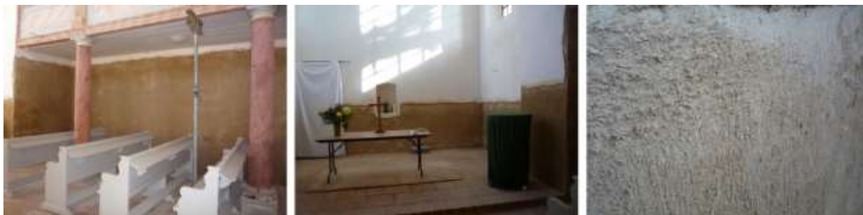
Abb. 1: Aktueller Wandputz innen (in abgeschlagener Zone)
