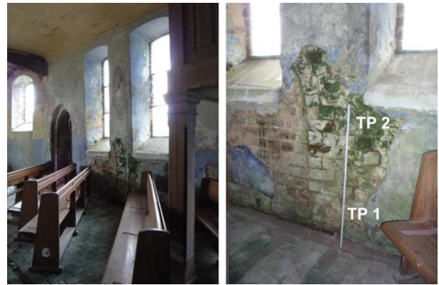
Abb. 10 Räbel, Kirche, erhebliche Schäden
