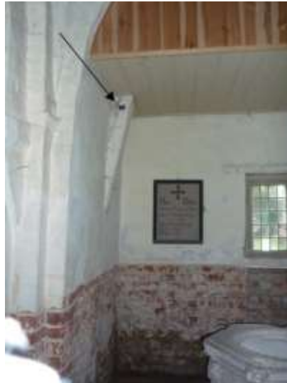
Abb. 5: Lokalisierung des Klimadatenloggers an der Nordseite des Kirchenschiffes, im Chorbereich, oberhalb der Profile TP 1 und 2
