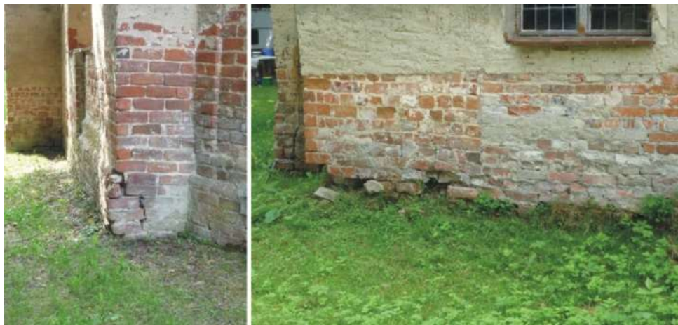
Abb. 7: Schäden am Mauerwerk der Kirche (Apsis und nördliche Chorwand)
