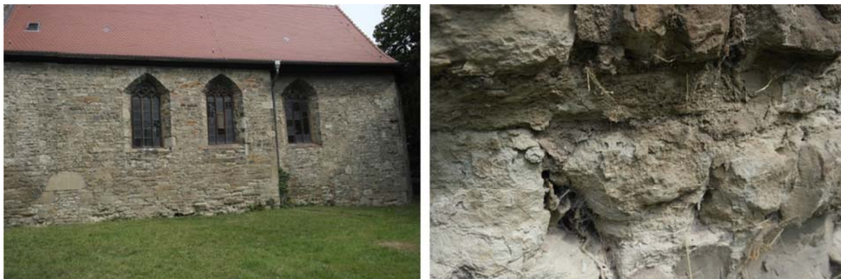
Abb. 14: Außenmauerwerk an der Südfassade der Kirche in Gottesgnaden mit z.T. desolaten Fugen im Sockelbereich
