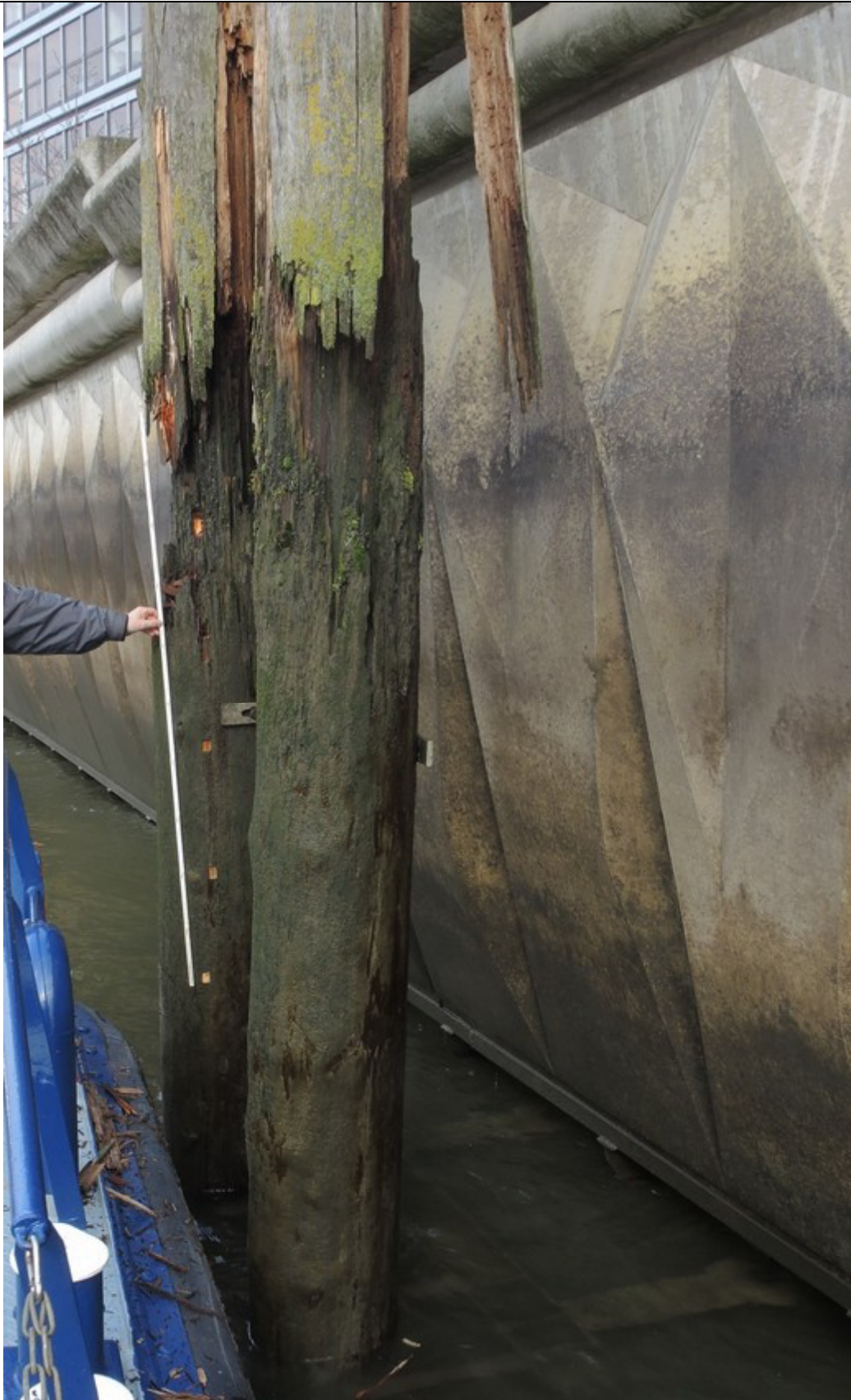
Abb. 17: Hamburg, Hafen am Großen Grasbrook, zweites Deko-Dalben-Paar am Anleger Elbphilharmonie, Dalbe mit Verteilung der Probenpunkte; erster Punkt ca. 60 cm über der Wasseroberfläche; Probennahme: 30.03.2017 (Bild: T. Huckfeldt).
