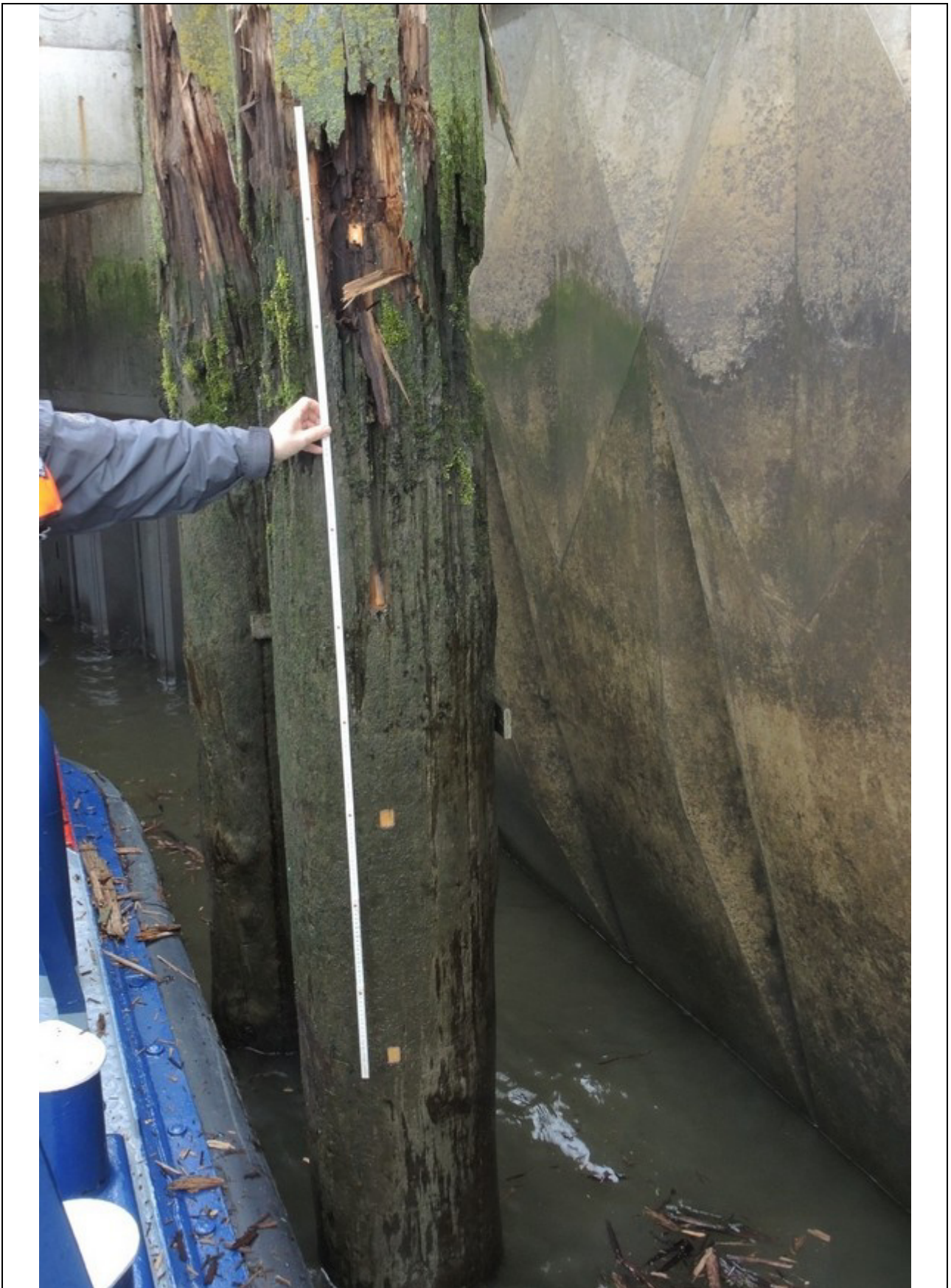
Abb. 16: Hamburg, Hafen – Großer Grasbrook, erstes Deko-Dalben-Paar am Anleger Elbphilharmonie, Dalbe mit Verteilung der Probenpunkte; erster Probennahme-Punkt ca. 50 cm über der Wasseroberfläche; Probennahme: 30.03.2017 (Bild: T. Huckfeldt).
