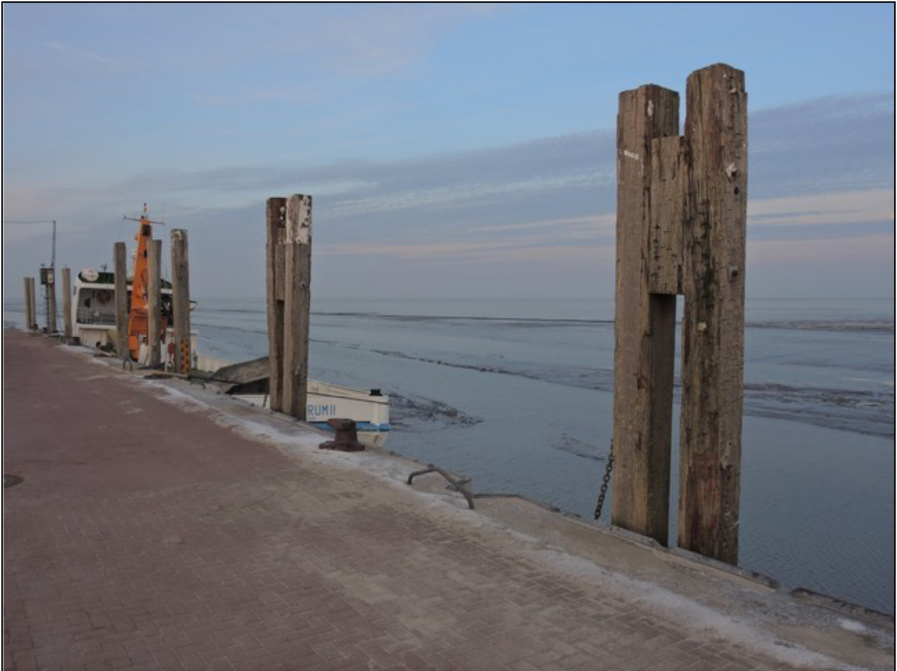
Abb. 1: Typische Dalben einer Hafenanlage mit sichtbaren Fäuleschäden (Nessmer-Siel, 22.01.2016); Eckbild: verdeckter Fäuleschaden nach Prüfung; das Holz war mit dem Daumen eindrückbar (Bild: T. Huckfeldt).
