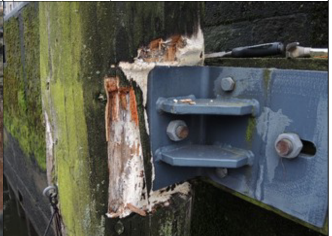
Abb. 24: Braunfäule-Erreger: Gelber Porenschwamm / Gelbe Braunfäuletramete ( Antrodia xantha ); Fundstelle: Hamburg; Am Sandtorkai; Südseite des Hafenbeckens; Dalben im Museumshafen, Probenpunkt 7; Kopf des Balkens (Bild: T. Huckfeldt).
