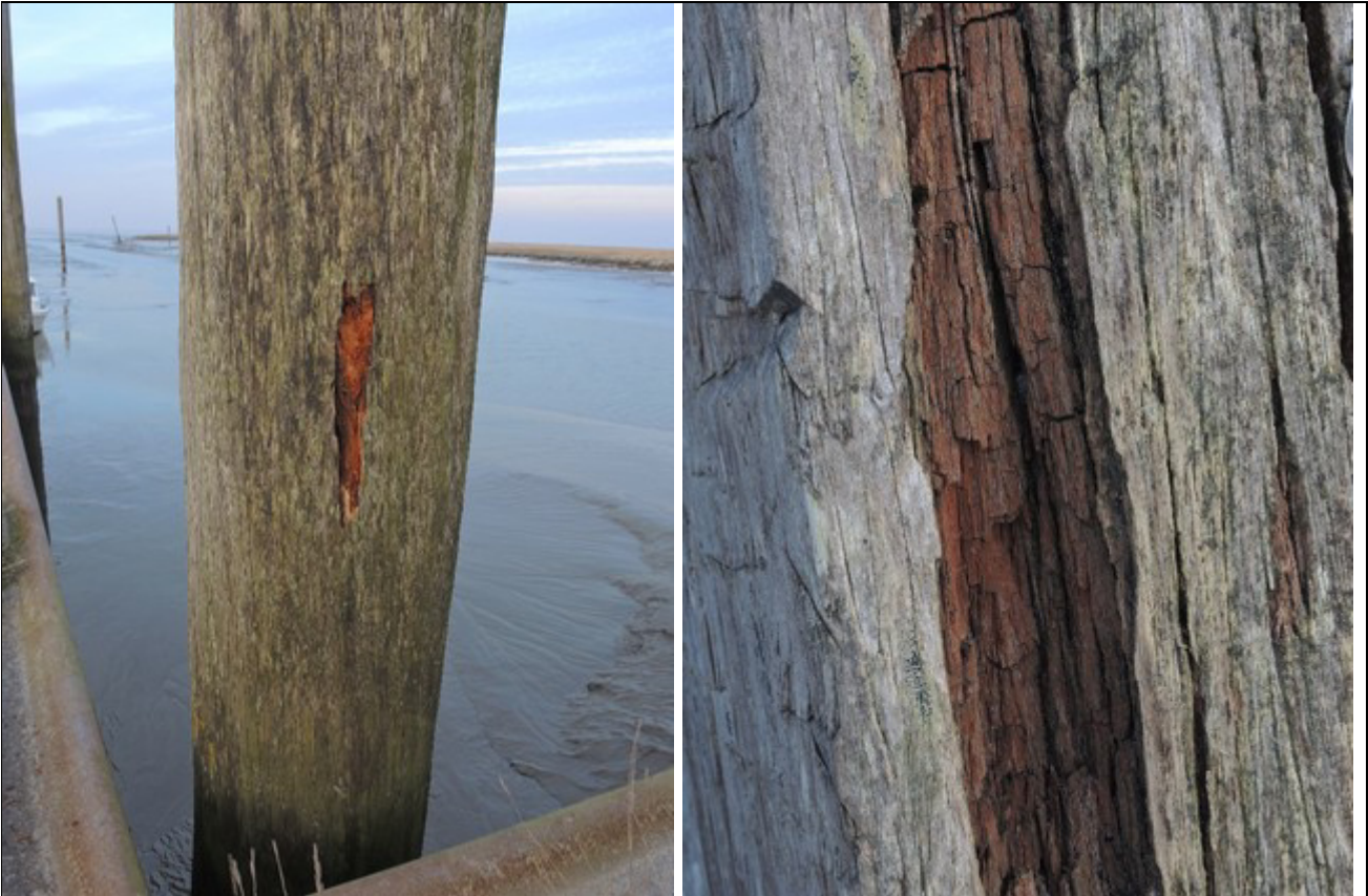
Abb. 12: Übersicht und Detail Nessmer-Siel (links); Südseite; rechts Probennahme: 22.01.2016; Pfahl 1; 0,8 m über Kai, Südseite, Nadelholz, Splint (Bild: T. Huckfeldt).
