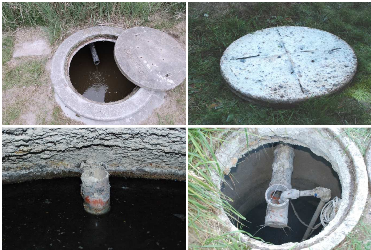
Abbildung 8.1: Korrosionsschäden an der Kläranlage des Zeltplatzes Nr. 2 im Jahr 2015 – A: Vorderseite der Schachtabdeckung, B: Rückseite der Schachtabdeckung, C: Konus der 1. Kammer der Vorklärung, D: Zulaufschacht
