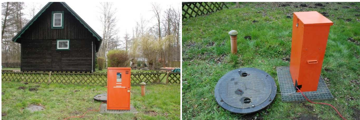
Abbildung 2.4: Dosierstelle für Grünsalz zur Ausfällung von Sulfid in der 2. Kammer der Vorklärung der KA Kanuheim Lübbenau
