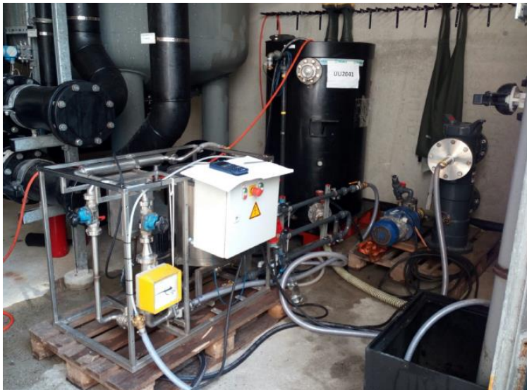
Abbildung 26: Cross-Flow-UF-Anlage der Fa. Wehrle
