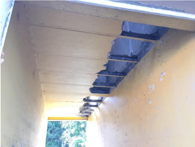
Abbildung 12: Korrodierte Stahlträger im eingebauten Zustand 81
