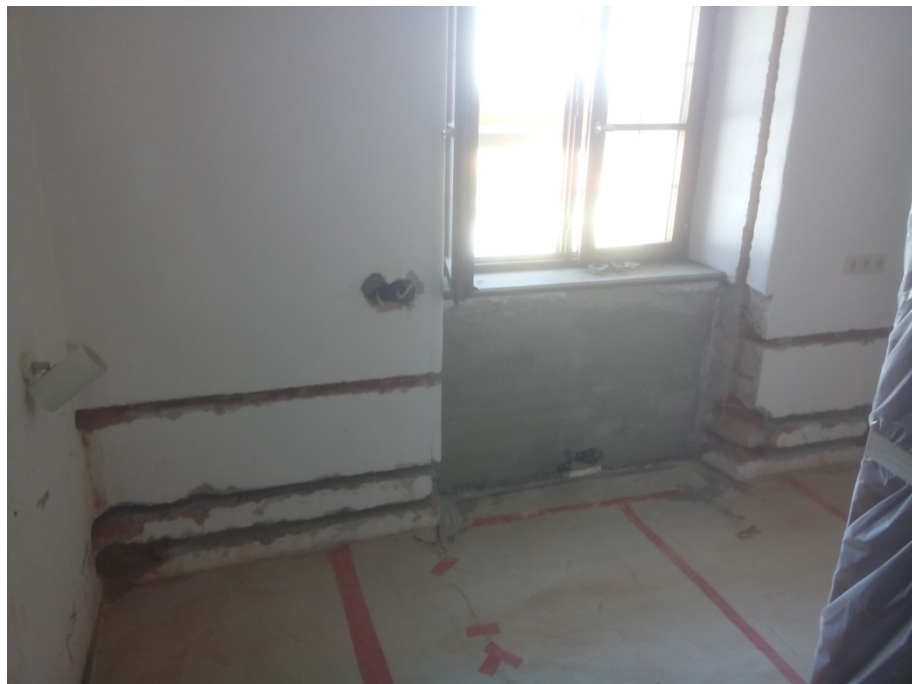
Bild 26: Wandansicht mit Fenster im Zimmer 2.29. Die Temperierleitungen sind im Sockel angebracht (untere zwei Schlitze). Der obere Schlitz ist für die Elektroinstallation vorgesehen. Die Temperierung wird konventionell, d.h. ohne Dämmung, eingeputzt (Bild: HPE).
