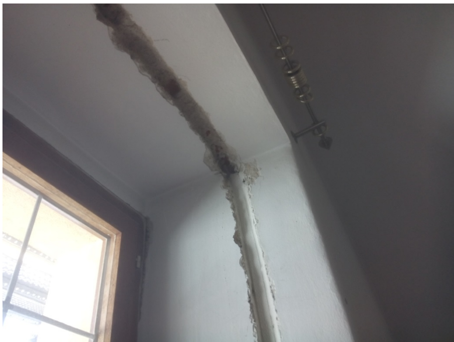
Bild 23: Vorbereitete Wandschlitz in der Fensterlaibung in Zimmer 2.27 mit bereits aufgetragenem Dämmputz. Der Schlitz im Sturz verbleibt aus statischen Gründen ungedämmt, da mit Dämmung der Schlitz tiefer eingearbeitet werden müsste und damit den Sturzbalken schwächen würde (Bild: HPE).
