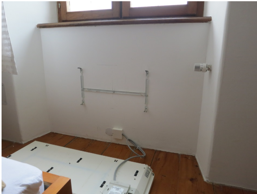
Bild 76: Detailaufnahme der Fensternische mit abmontierten elektrischen Konvektor am Boden liegend.
