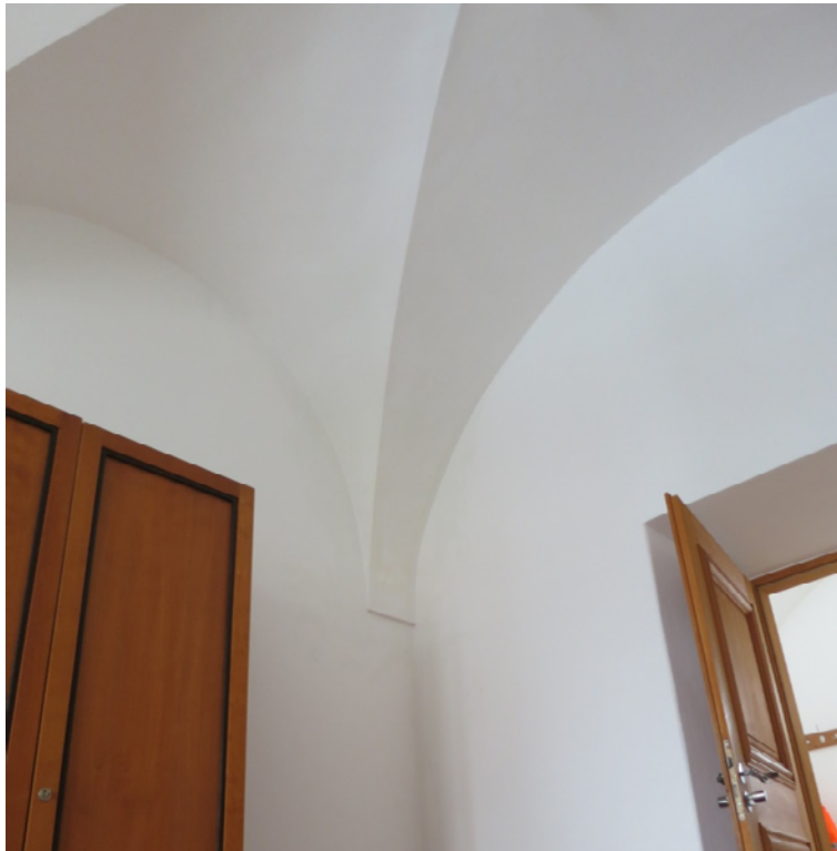
Bild 88: Detailaufnahme der Kreuzgewölbedecke im Bereich des Wasserschadens im Raum 2.30 (Türnummer 202).
