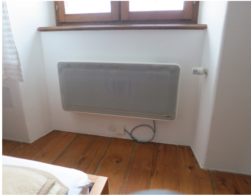
Bild 74: Visuelle Aufnahme im Raum 2.27 (Türnummer 205) in der Fensternische. Rechts neben dem Konvektor ist der Thermostatkopf erkennbar, der die zusätzliche Heizschleife in der Laibung abhängig von der Raumtemperatur regelt.
