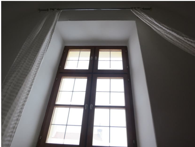
Bild 72: Abbildung des Fensters mit Fensterlaibung im Raum 2.27 (Türnummer 205). Die Außenwand wird mit einer Sockelschleife temperiert sowie mit einer zusätzlichen Heizschleife in der Laibung. In der Nische ist ein zusätzlicher elektrischer Konvektor montiert.
