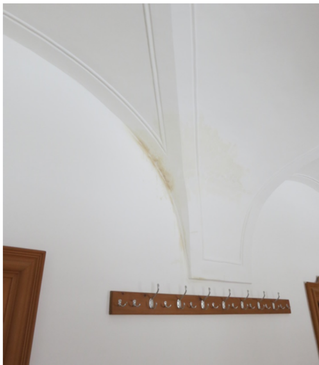
Bild 92: Detailaufnahme der Kreuzgewölbedecke im Flur zwischen Raum 2.30 (Türnummer 202) und 2.31 (Türnummer 201) im Bereich des Wasserschadens.
