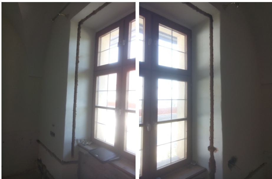
Bild 28: Ansicht der linken und rechten Laibungsseite mit den vorbereiteten Schlitzen in der Fensterlaibung im Zimmer 2.30. Die Schlitze wurden 4 cm x 4 cm groß hergestellt. Die Temperierung wird konventionell, d.h. ohne Dämmung, eingeputzt (Bild: HPE).
