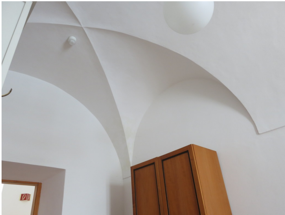
Bild 90: Detailaufnahme der Kreuzgewölbedecke im Bereich des Wasserschadens im Raum 2.31 (Türnummer 201).
