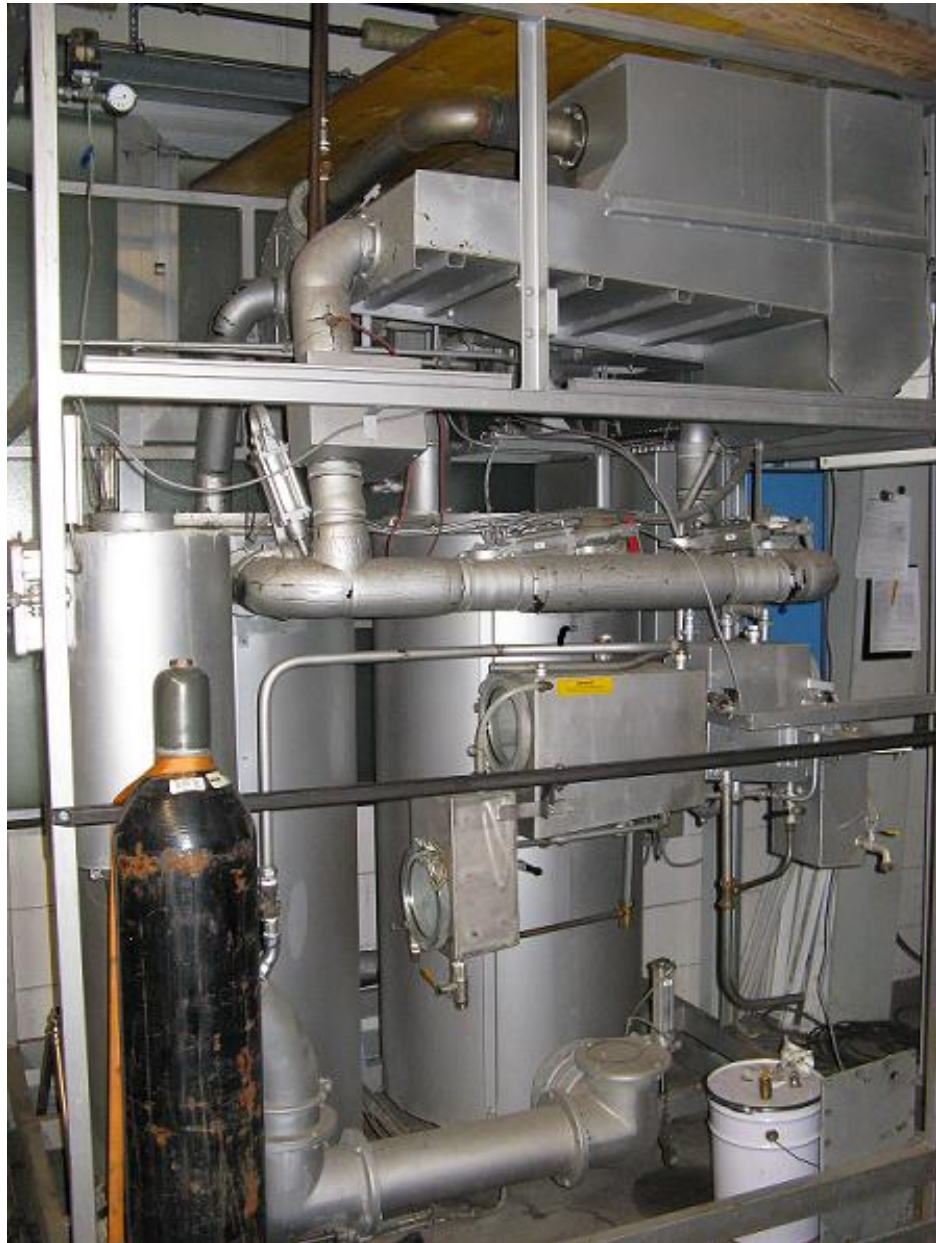
Abbildung 5: Versuchsaufbau mit den beiden Aktivkohlebehältern und den Wasserabscheidern vorne rechts, die in Serie geschaltet sind.
