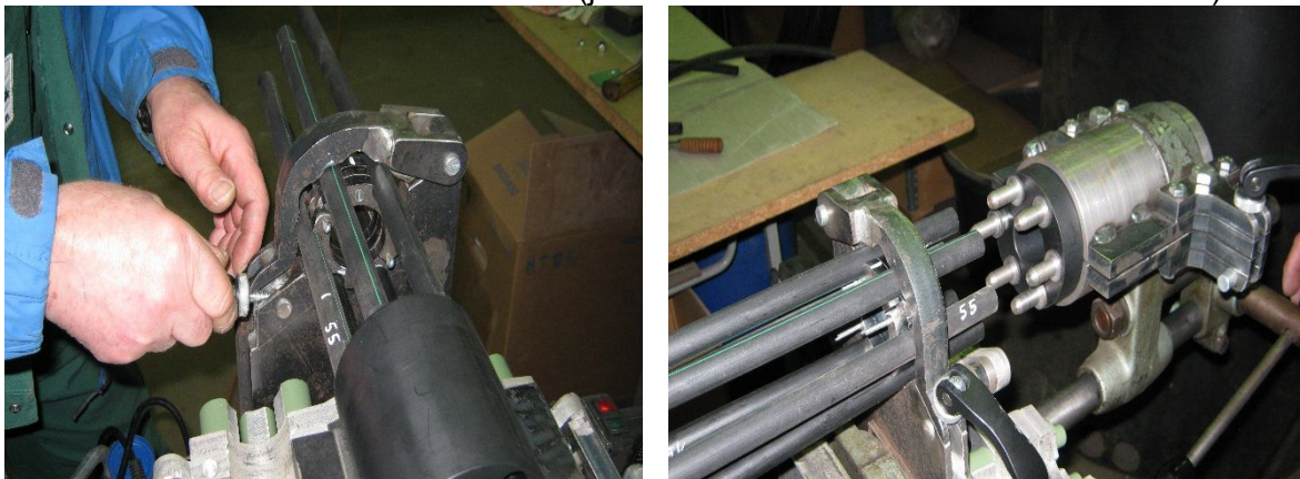
Abbildung 39: Detailaufnahme der Spannvorrichtung / Zentrierstifte zur Überprüfung bzw. Ausrichtung der Rohre zum Kunststoffblock
