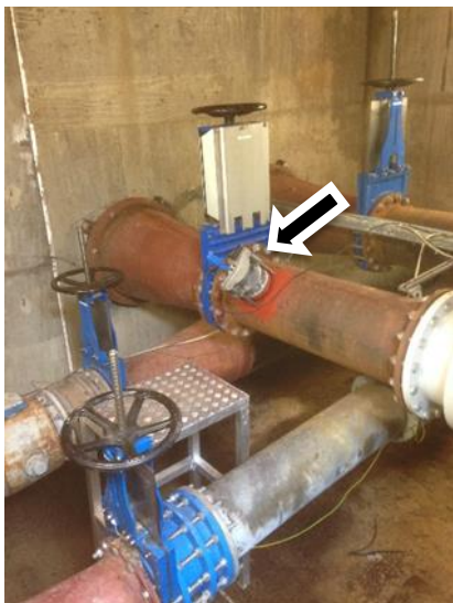
Abbildung 15: Feststoffsonde ZKA-Rostock, Abwasser von links kommend vom APW-Schmarl
